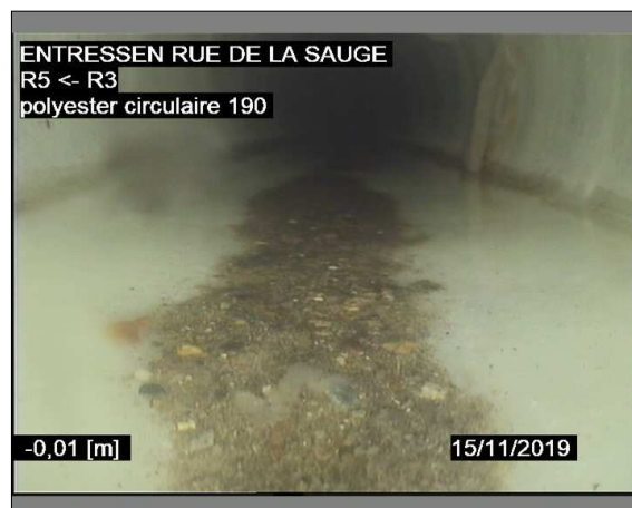
Photo: 9_1B, 00:00:00 -0,01m, Noeud de départ, regard de visite R5 / DEBUT ITV FINALE
