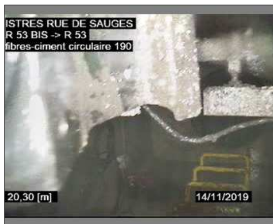
Photo: 4_4B, 00:03:36 20,74m, Remarque générale: / Débitmètre
