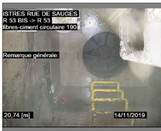
Photo: 4_4A, 00:03:36 20,74m, Remarque générale: / Débitmètre
