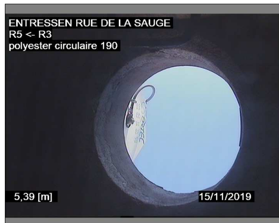
Photo: 9_2B, 00:01:03 5,08m, Noeud d'arrivée, regard de visite R3 / FIN ITV FINALE
