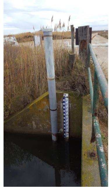
Figure 8 : photographies de l'installation de la sonde de niveau à l'exutoire du canal du Versadou (n°1 sur la Figure 7)
