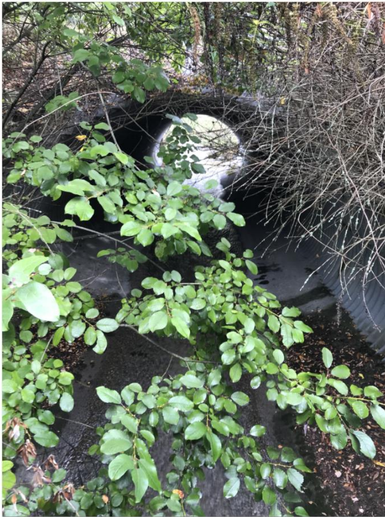
Figure 44 : Passage en buse sous la RD
