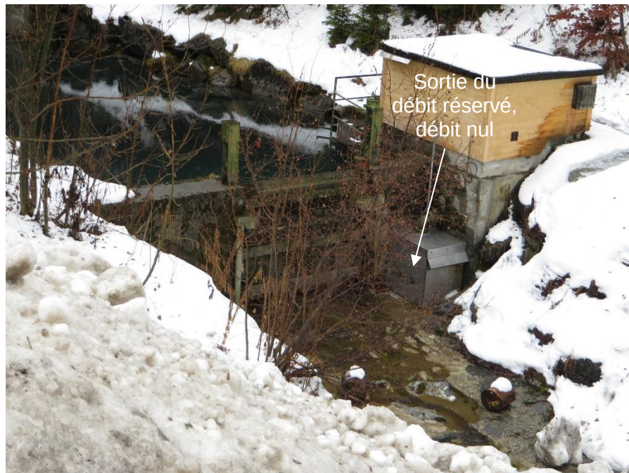
Prise d'eau hydro-électrique – 31.01.2017
