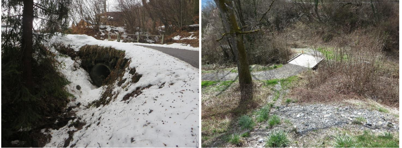
Ouvrages pouvant engendrer des débordements – sans conséquences majeures
