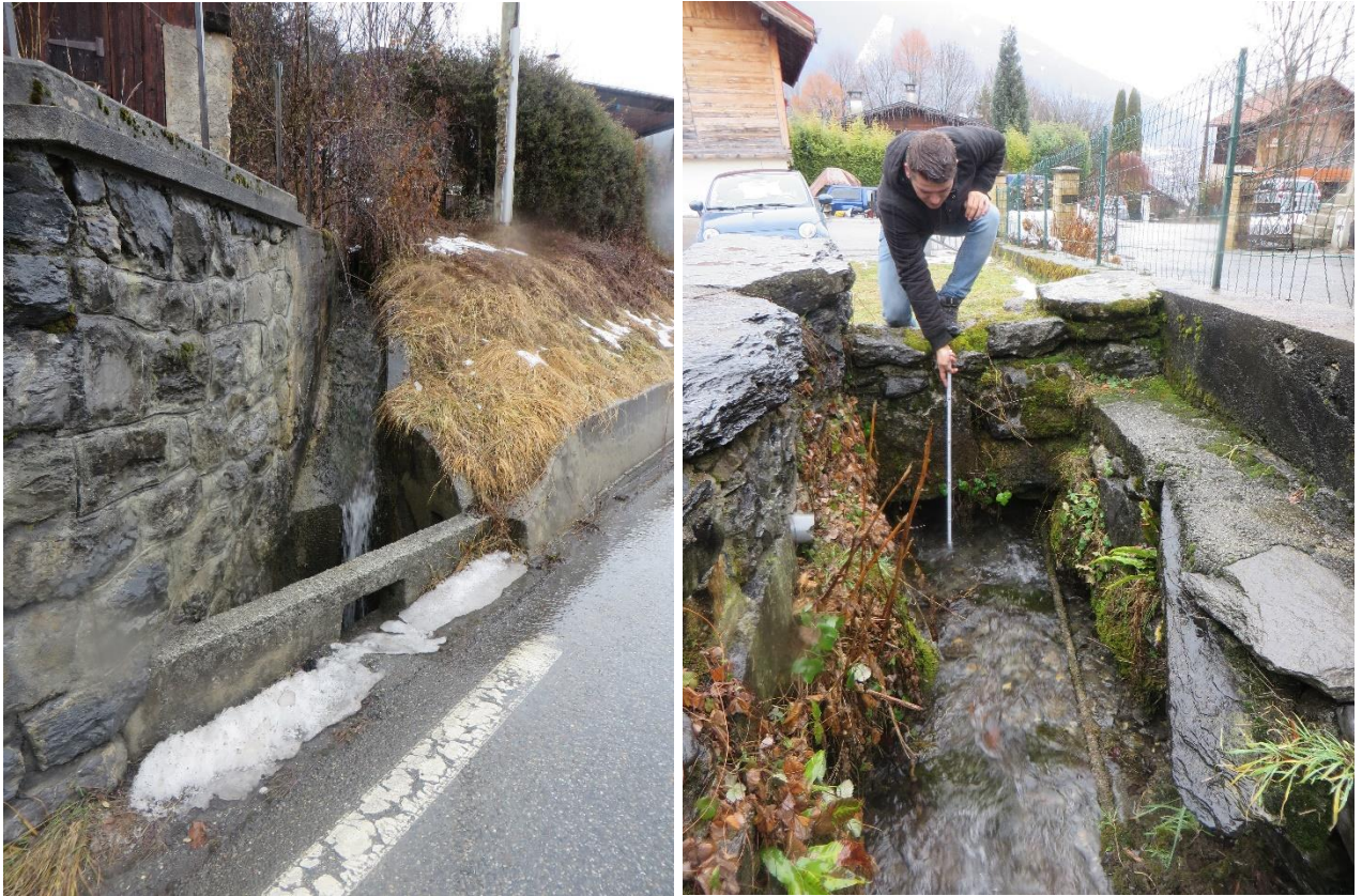
Ouvrages de petits gabarits pouvant créer des débordements vers des habitations
