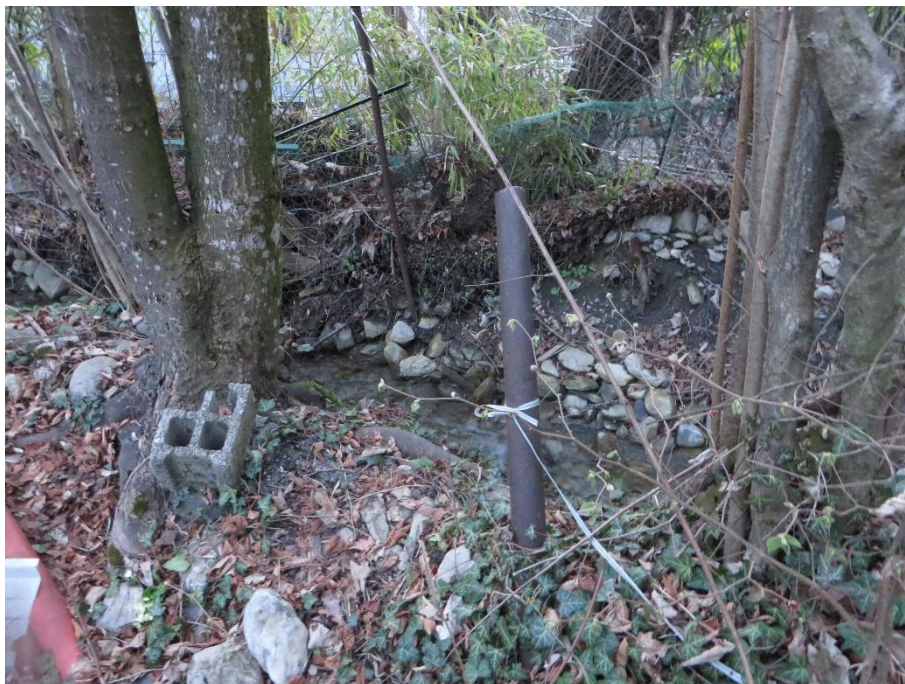
Point faible en face des propriétés privées – point qui a été sujet à un débordement le 29 mai 2017
