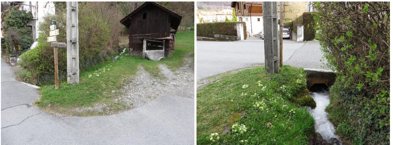
Capacité du lit et des ouvrages très limitée – risque de débordement important dans la plaine
