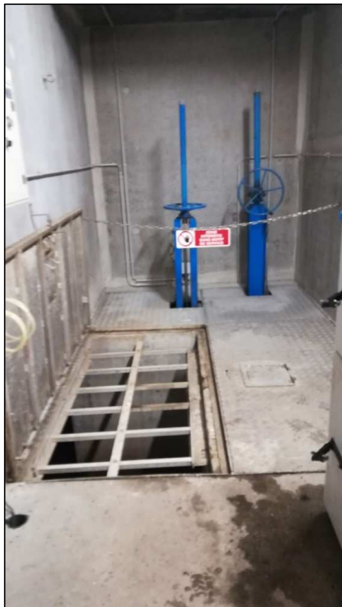
Figure 71 : Canal de rejet et vannage pour envoi des eaux traitées
