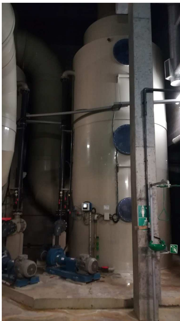
Figure 65 : Tour de désodorisation au sein de l'UDEP des Trabets
