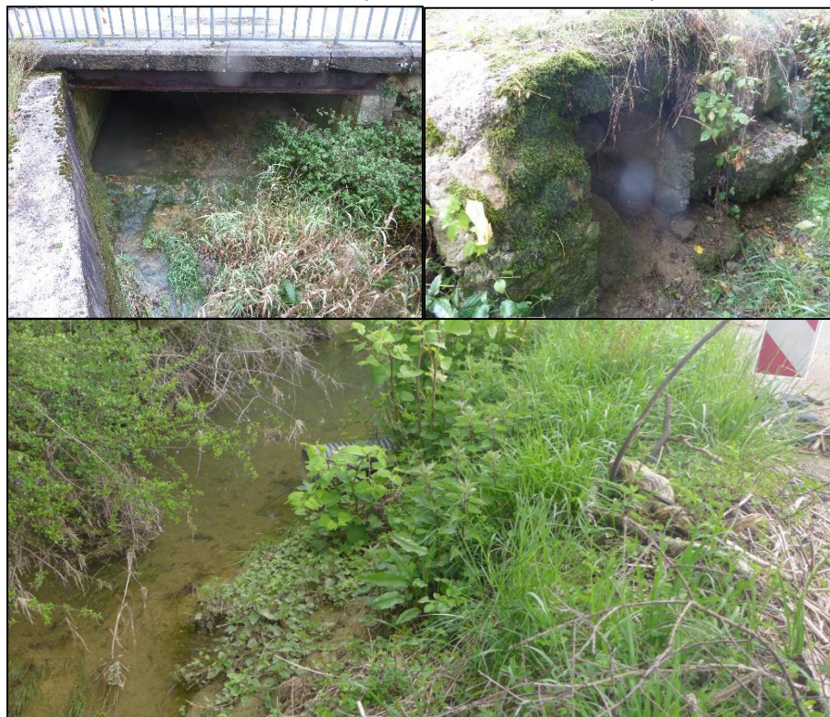
Figure 18 : Ouvrage OA3, permettant le franchissement de la RD77 par le Nantay (source : BIOTEC octobre 2016) et Illustrations d'un des exutoires dans le Nantay des canalisations diamètre 300 franchissant la RD77 (source : BIOTEC octobre 2016)
