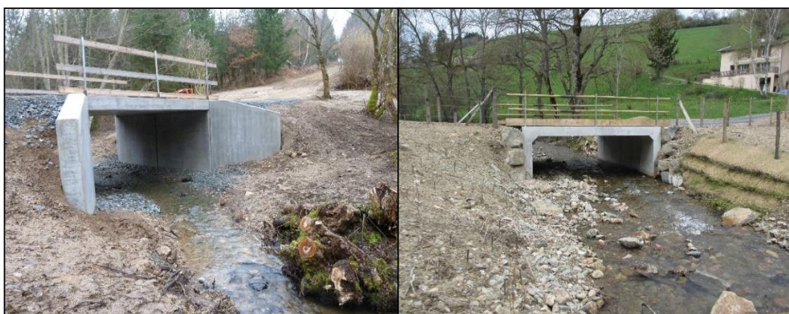
Figure 21 : Exemples d'ouvrage de type PIPO mis en place sur la Dronne (commune de Bussière Gallant-87, photo gauche) puis sur le Boussivre (Commune de Saint Marcel l'Eclairé-69, photo droite), maîtrise d'œuvre assurée par les soins de l'équipe BIOTEC.
