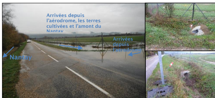
Figure 9 : Illustrations des débordements sur voirie survenus en novembre 2014 (source : SBVA novembre 2014) et des ouvrages de gestion des eaux pluviales vraisemblablement insuffisant (source : Biotec octobre 2016)
