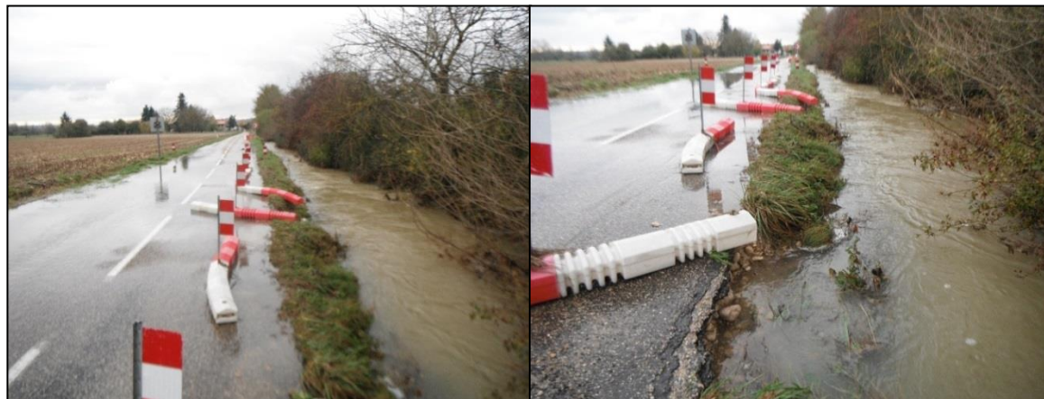
Figure 11 : Erosion du talus routier induite par le travail naturel du Nantay sur sa rive gauche (source SBVA : novembre 2014)
