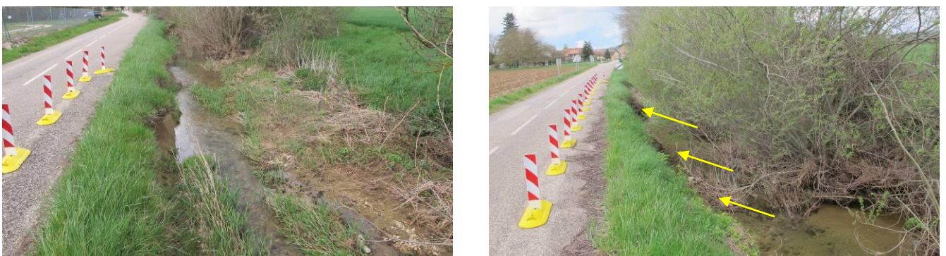
Figure 3 : Illustration des « fronts d'érosion » en rive gauche qui, à court terme, vont remettre en cause la stabilisation de l'enrobé de la voirie puis illustration de la végétation arbustive qui par son système aérien contribue à jouer le rôle d'épis en renvoyant le flux vers la berge opposée - Clichés Biotec, avril 2016.
