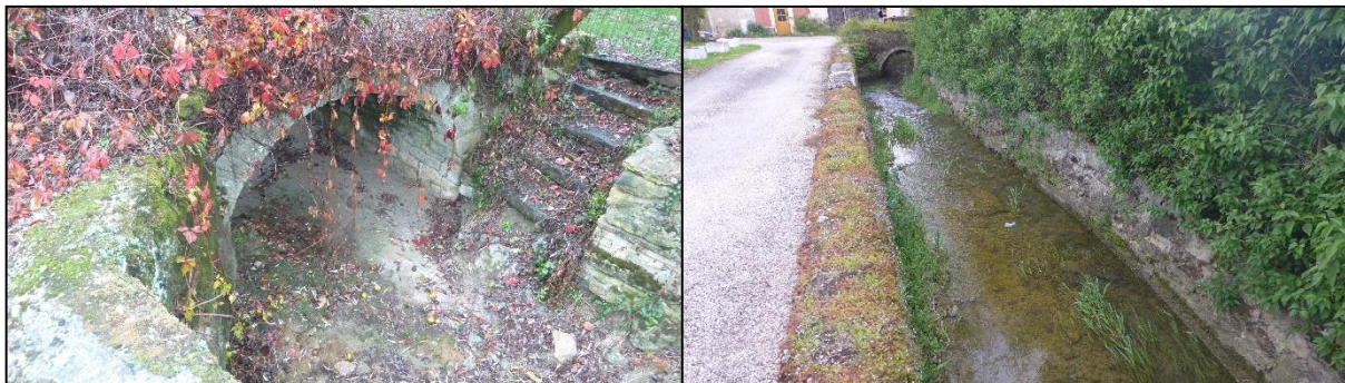
Figure 20 : Illustration des deux ouvrages dimensionnés pour une période de retour proche de la biennale (OA6 à gauche et OA7 à droite) dans la traversée de la Championnière (source BIOTEC, septembre 2016)
