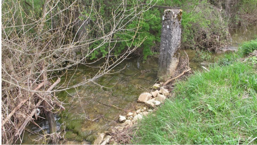
Figure 1 : Illustration des vestiges d'un ouvrage de type vanne guillotine qui aurait pu servir à favoriser les débordements au droit des terres cultivées dans l'objectif de fertiliser ces dernières.
