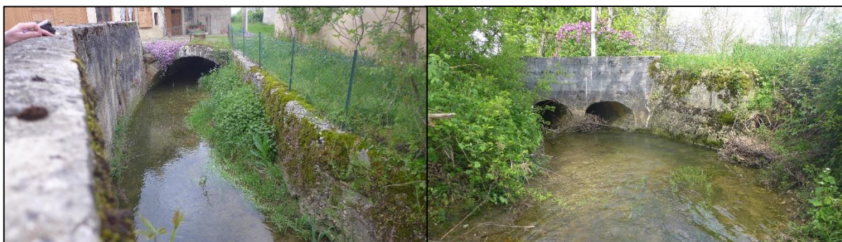
Figure 19 : Illustration des deux ouvrages nettement sous dimensionnés pour une période de retour biennale (OA8 à gauche et OA10 à droite) dans la traversée de la Championnière (source BIOTEC, septembre 2016)
