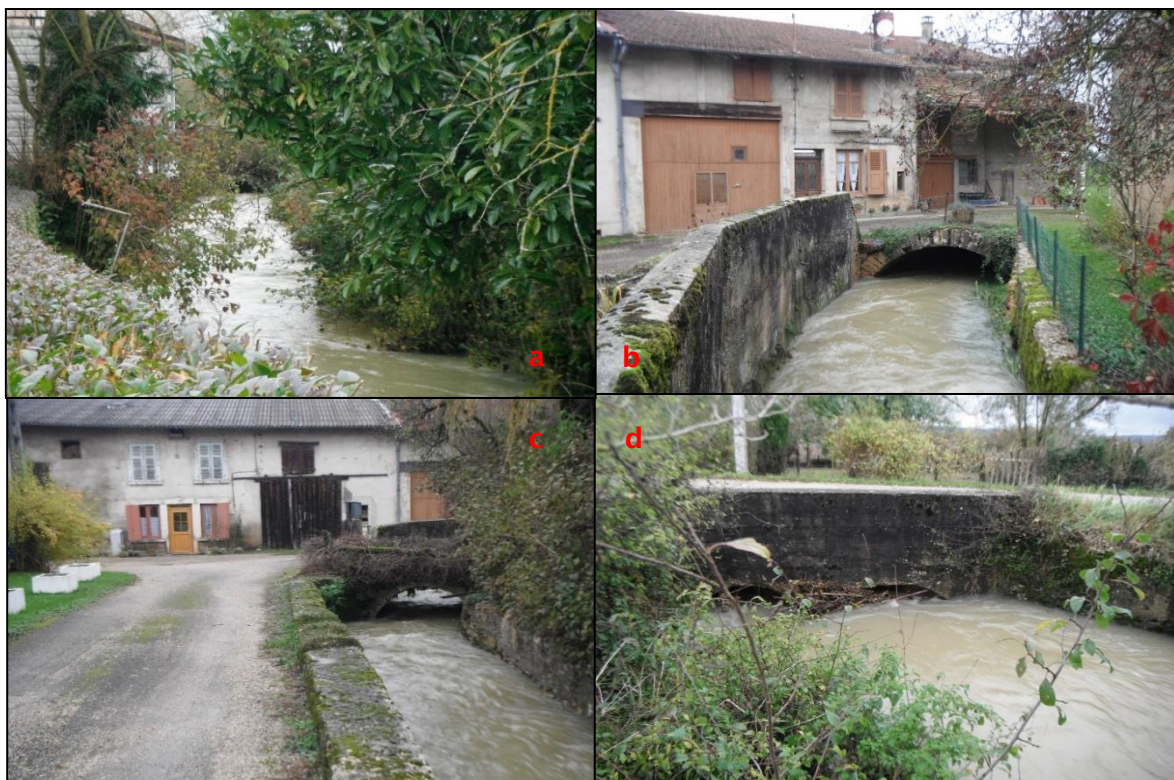
Figure 12 : Illustration de quatre des cinq ouvrages de franchissement du Nantay dans la traversée de la Championnière avec notamment l'arche sous bâtiment (photo b) et les deux canalisations diamètre 1000 sous la voirie communale (photo d), tous deux concernés par des mises en charge dès des crues courantes (les photographies ont été réalisées en novembre 2014 par le SBVA pour un événement pluvieux de 41 mm, soit une période de retour nettement inférieure à la décennale si on considère une durée de pluie de 12 ou 24 heures)
