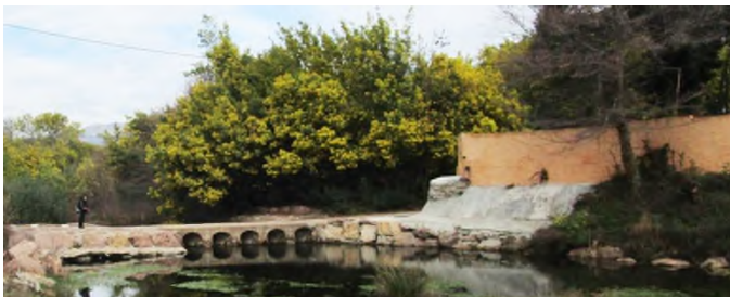
9 - Surface bétonnée inesthétique au niveau du gué (mur privé d'un camping)
