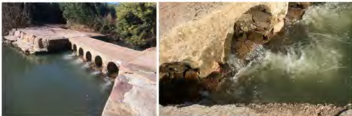
Photos 12 et 13 : Passage à gué du Pas de la Charrette par débits faibles – Vue d'ensemble (à gauche) – Détail d'une chute à l'aval d'une buse (à droite).
