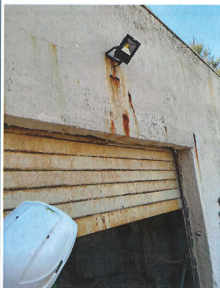
Corrosion des acier / porte
