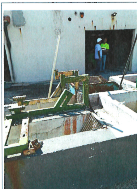
Absence de dégrilleur
