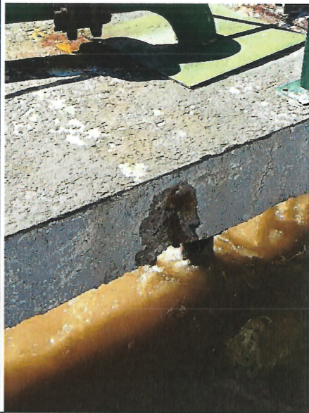
Désorgre sur béton / acier corrodé /
