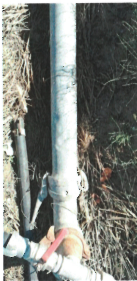
Canalisation en acier
