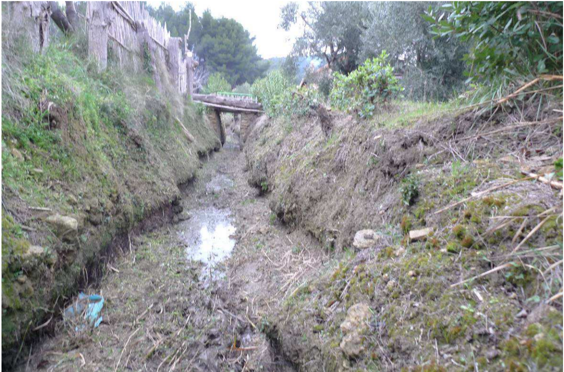
Irrégularité de berge sur le canal de la Dent suite à un glissement (au premier plan à droite)
