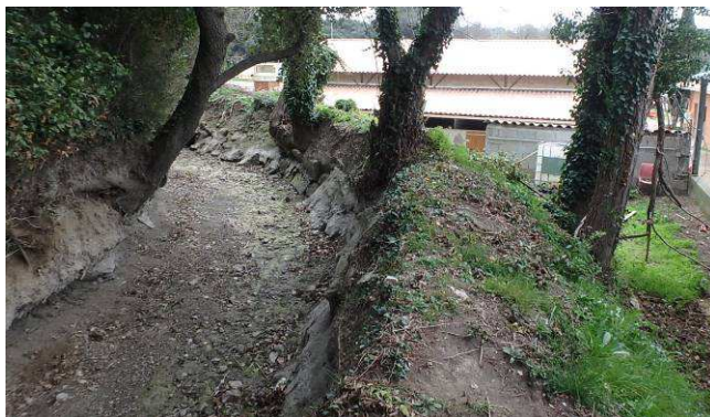
Canal au-dessus du centre équestre. Digue étroite, protection béton sommaire
