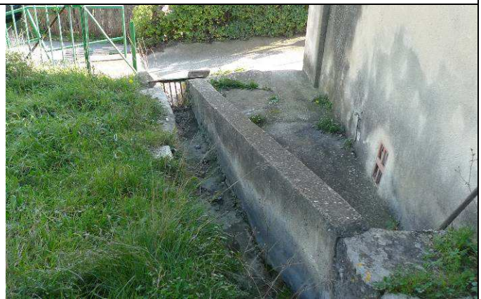
Tronçon à forte pente à l'aval du canal et dégrilleur à l'aval
