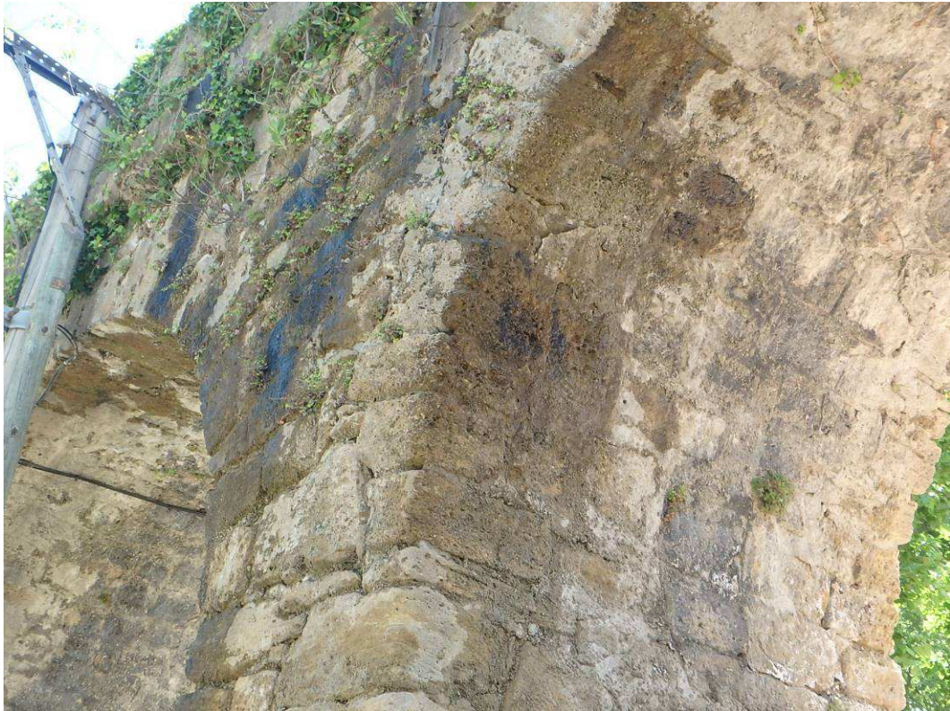
Fuites à travers la maçonnerie à proximité de la RD10
