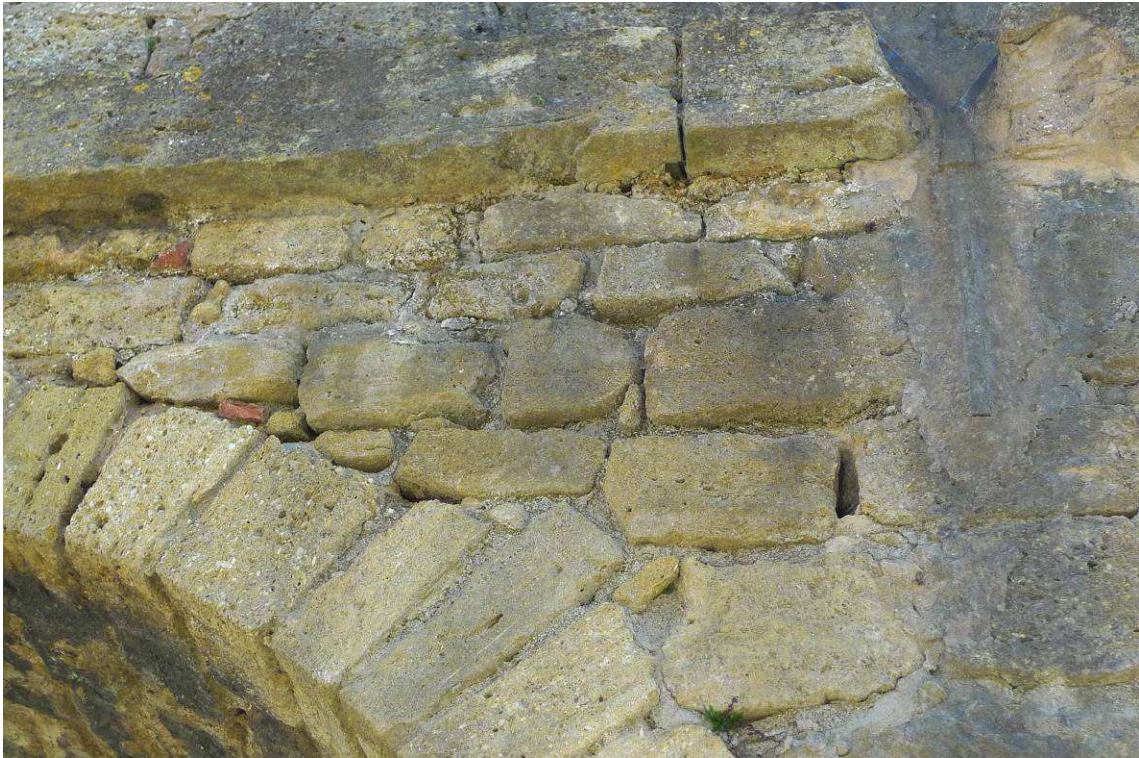
Dégradation des joints du tympan
