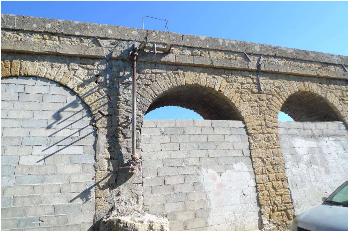
Mur de parpaings construit sous l'ouvrage, empêchant l'accès au côté rive gauche
