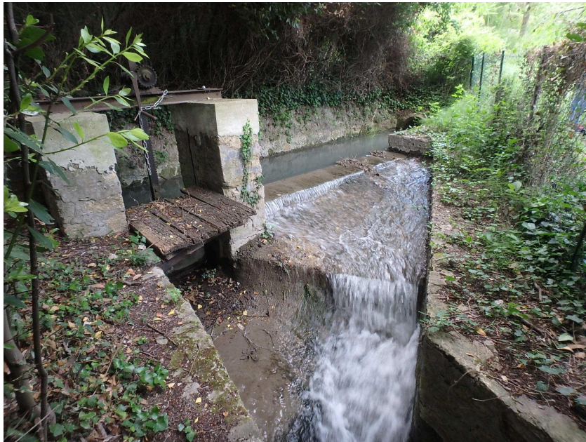
Déversement vers le canal de la Poudrerie (19/05/2016).
