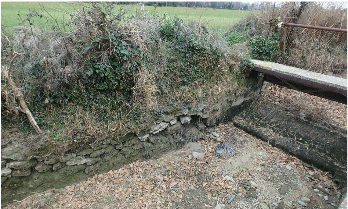
Dégradation de maçonnerie liée au ressaut à l'aval de l'ouvrage (canal commun au droit de la prise du canal du Pougnois)
