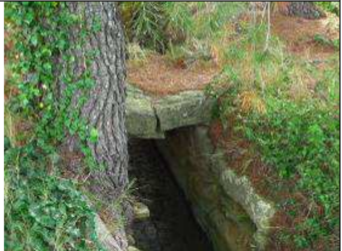
Pierre d'un ouvrage de franchissement fendue
