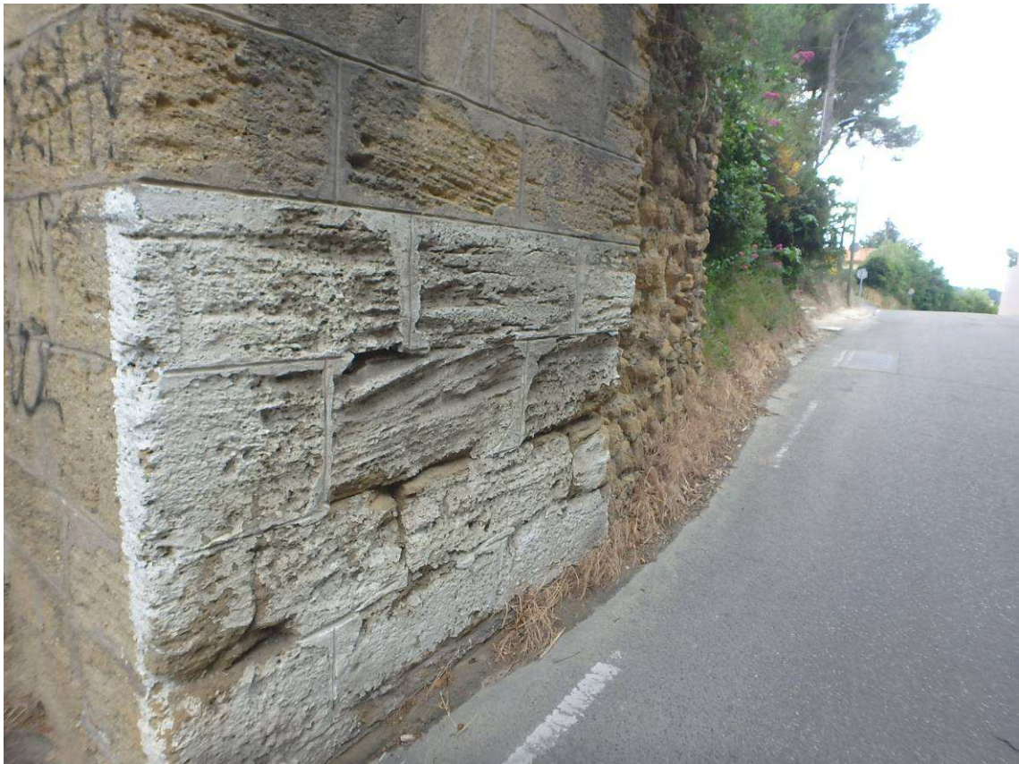
Erosion éolienne en base du pied-droit
