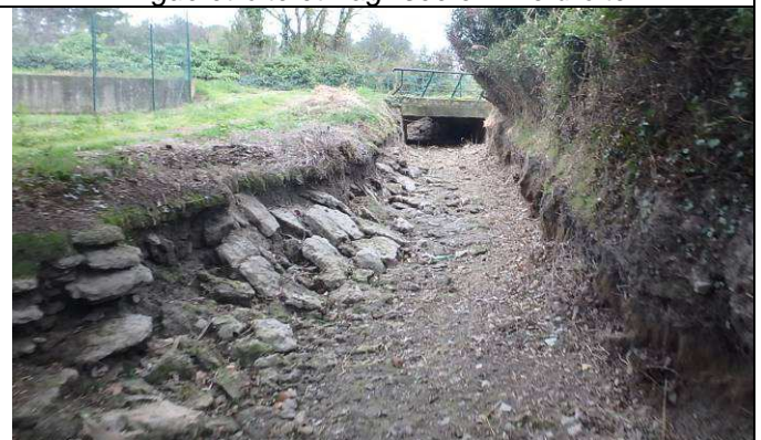
Maçonnerie en ruine à l'aval du tronçon
