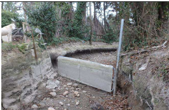
Barrière pivotante pour la régulation de niveau
