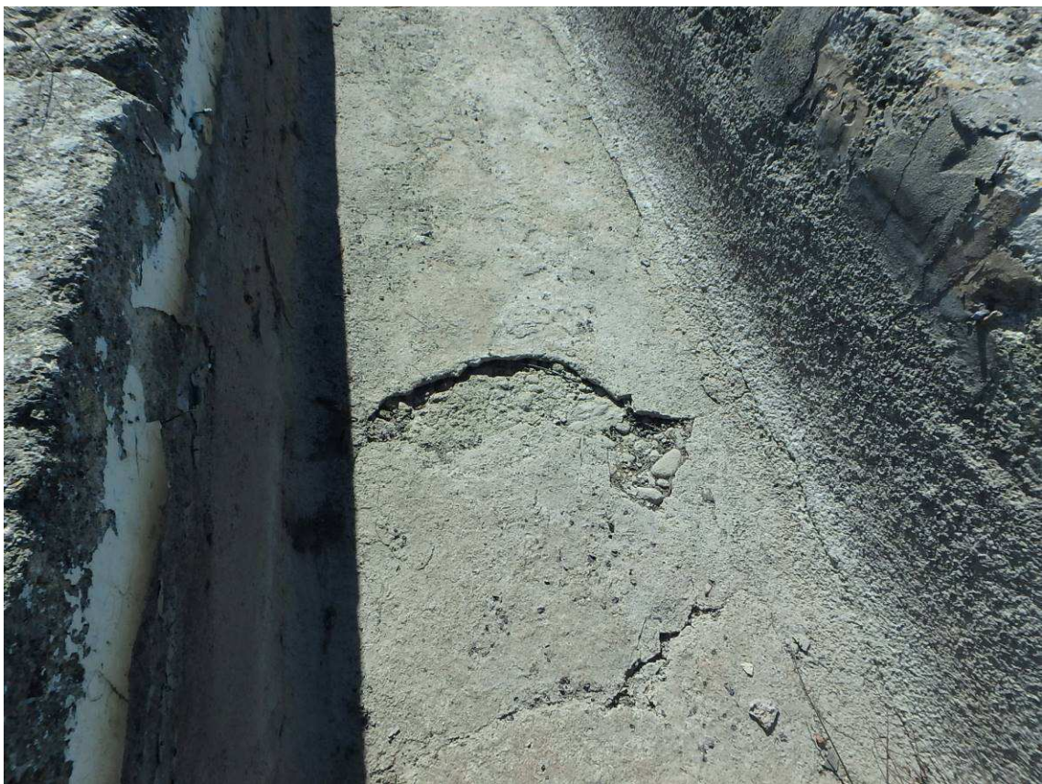
Décollement d'enduit sur les parois et en fond de canal
