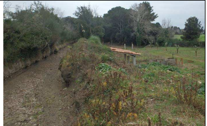
Digue étroite et fragilisée en rive droite
