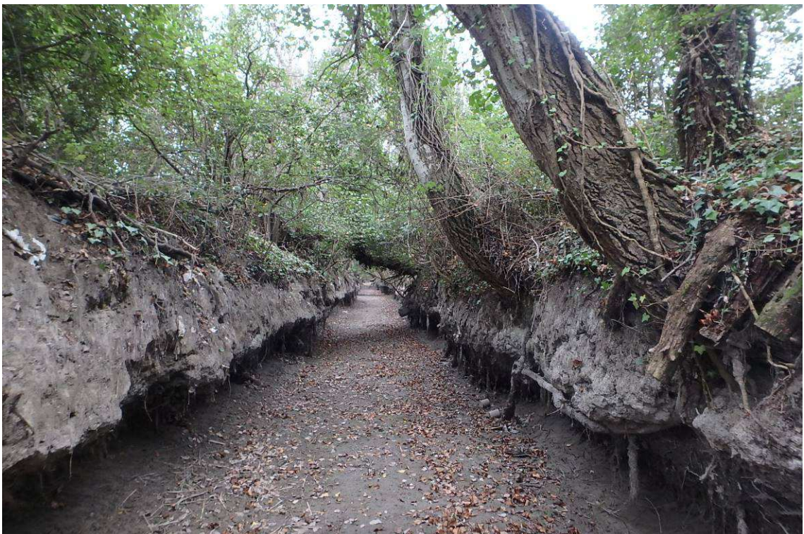
Affouillement de pied de berge et développement de végétation inadaptée sur le canal commun
