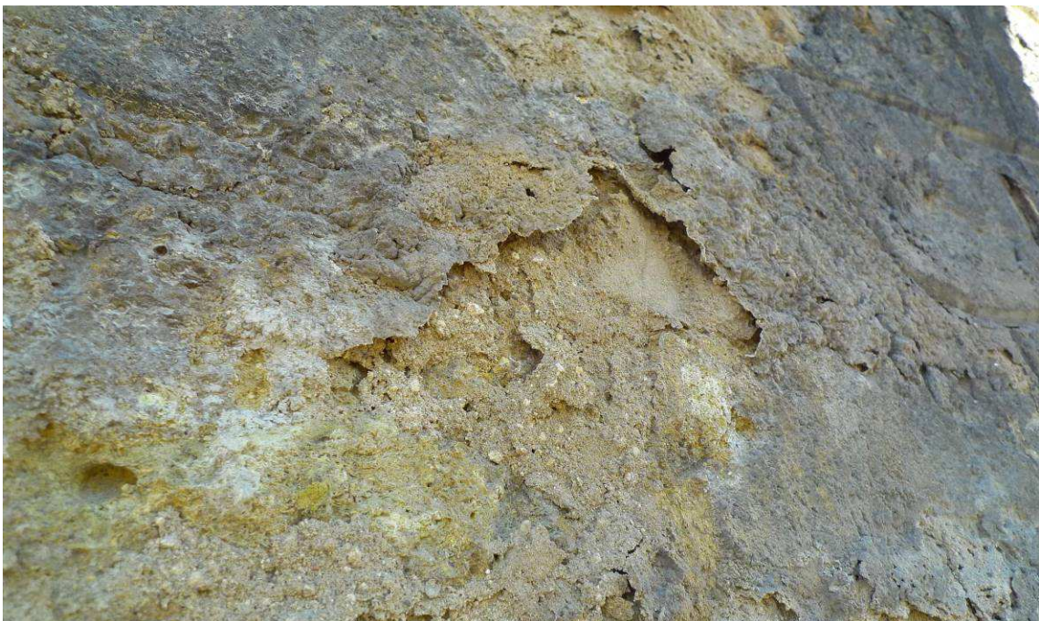
Erosion éolienne et effritement de la maçonnerie de la voûte
