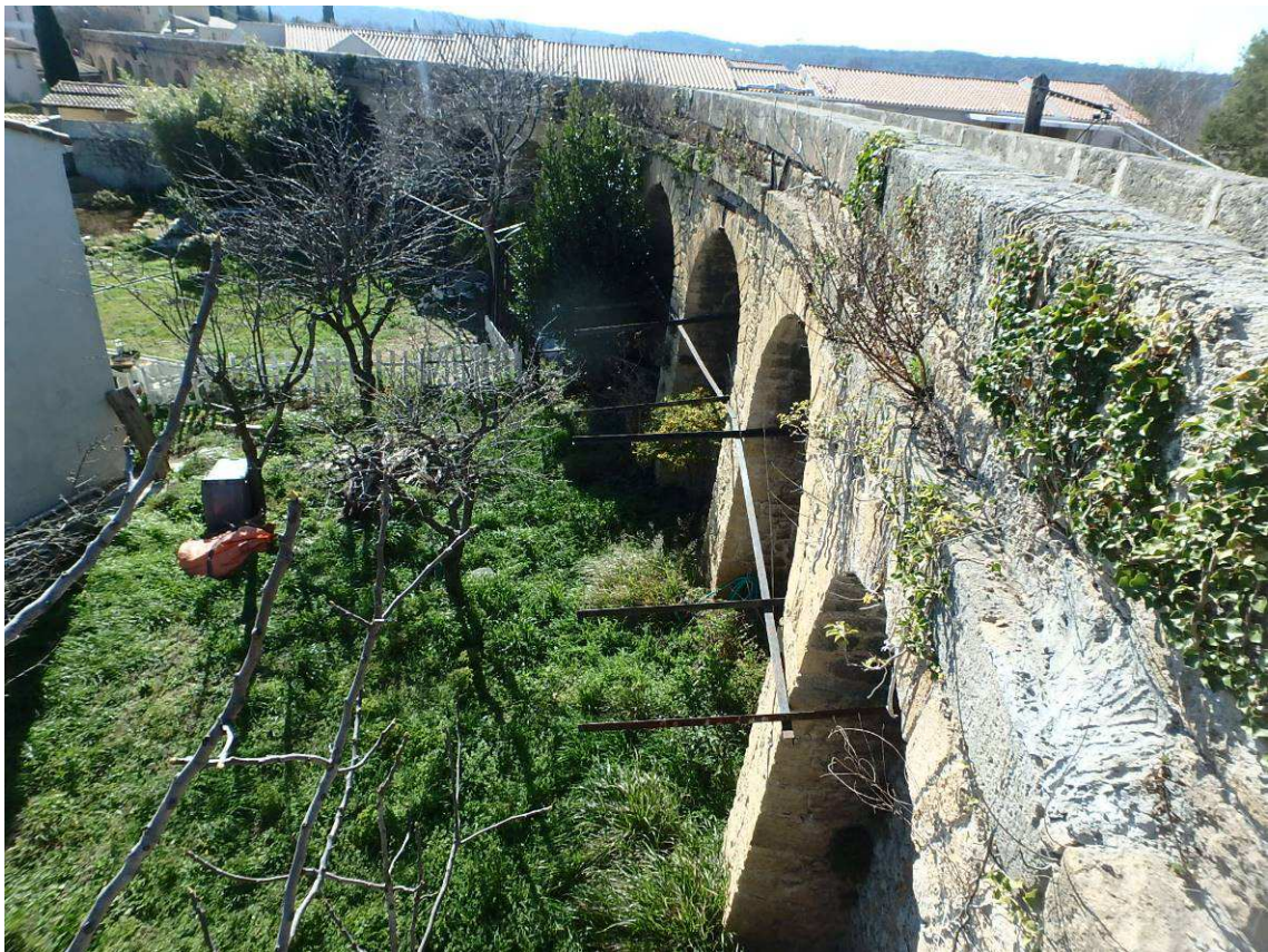
Développement de végétation sur l'ouvrage
