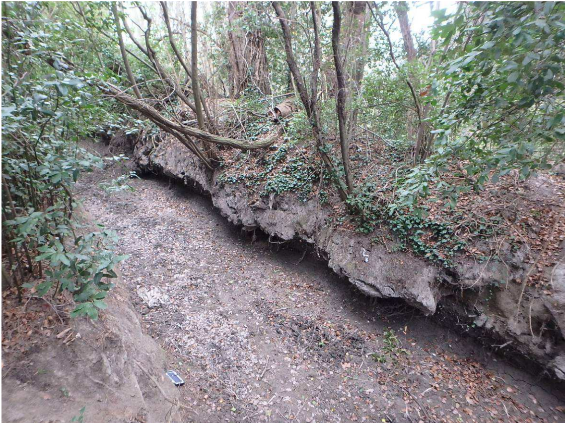
Accumulation de matériaux de curage en berge, végétation inadaptée et affouillement de pied (risque d'effondrement) sur le canal commun.
