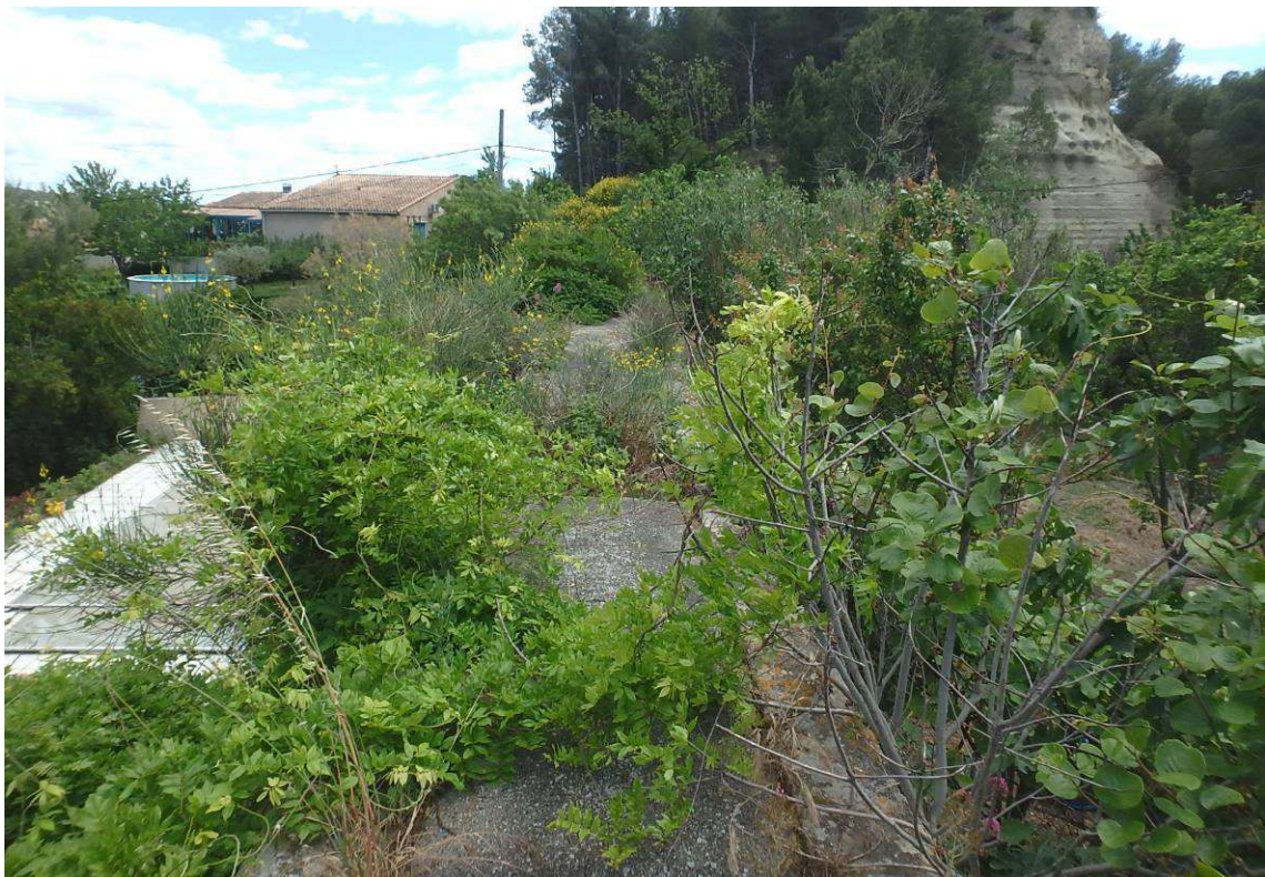
Développement de végétation sur et en bordure de l'ouvrage
