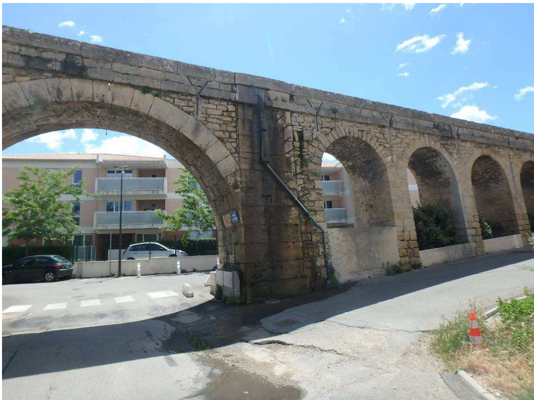
Fuite importante au droit de l'impasse de l'aqueduc
