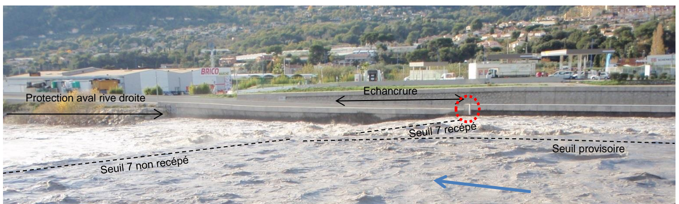
Figure 31 : Mur de la trémie côté Var lors de la crue du 26/11/2016 (vers 15 h, soit Q~800 m 3 /s)
