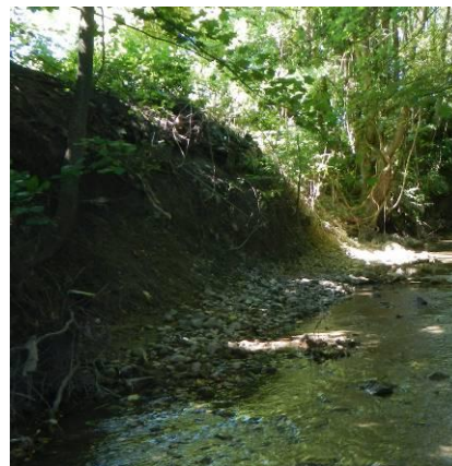
Photo 7 : Berge mise à nu
