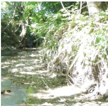
Photo 6 : Système racinaire mis à nu en rive gauche
