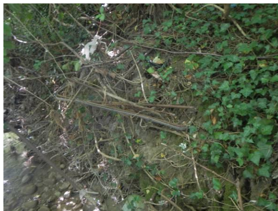
Photo 25 : déchet métallique ancré dans le corps de digue en rive droite
