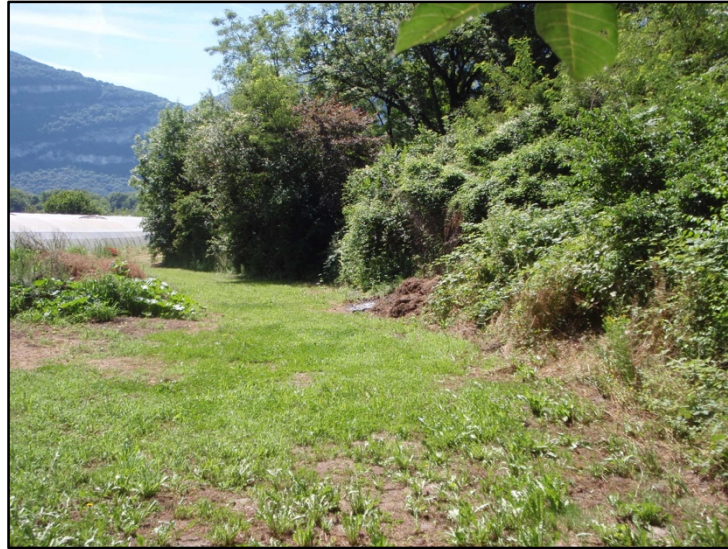
Photographie 19 : Digue fortement végétalisée pk480 à 560
