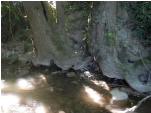
Photo 4 : Abris en berge créé par sous cavage d'arbres en rive droite
