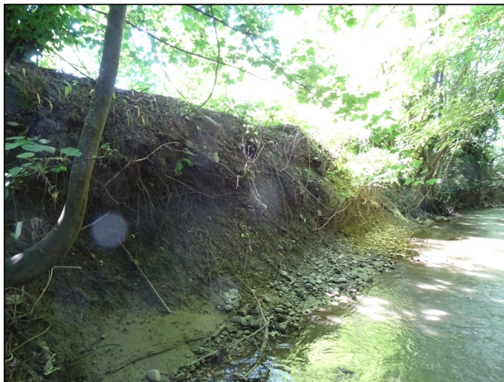
Photographie 27 : loupe glissement et ravinelements pk 80
