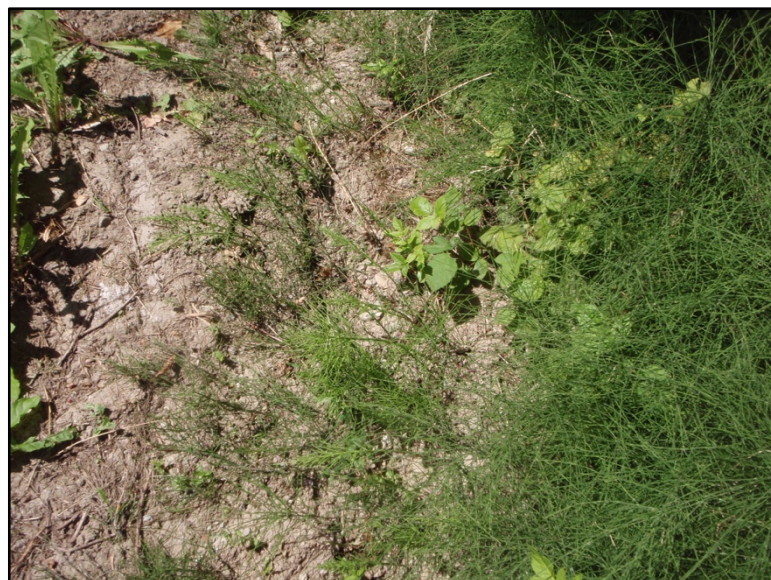
Photographie 8 : fissures observées en tête de talus au droit du pk 330
