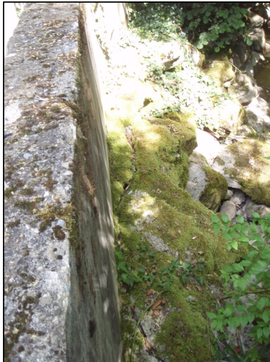
Photographie 24 : muret reposant directement sur les enrochements en limite de stabilité
