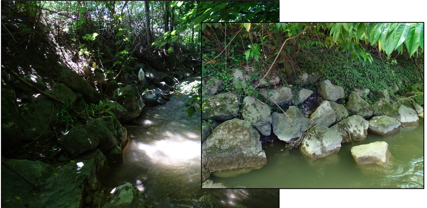
Photographie 6 (gauche) : enrochements déstructurés du pk 280 au pk 320 / Photographie 7 (droite) : blocs déchaussés pk300 à 320
