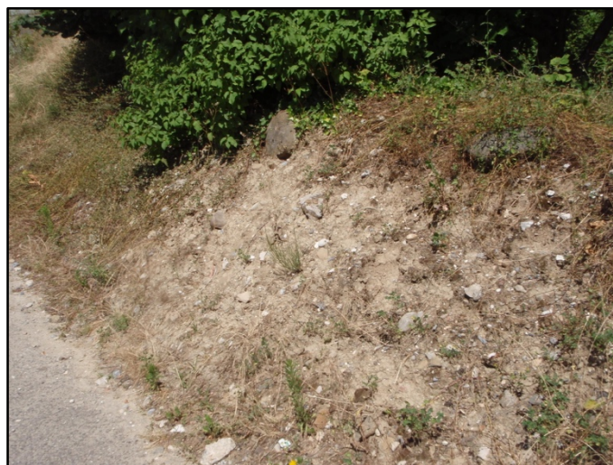
Photographie 16 : talus de la digue côté terre érodé (pk400)
