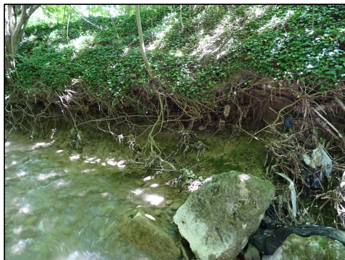
Photographie 13 : érosion importante du pied de talus à la transition enrochements libres / talus de déblais au niveau du pk 470
