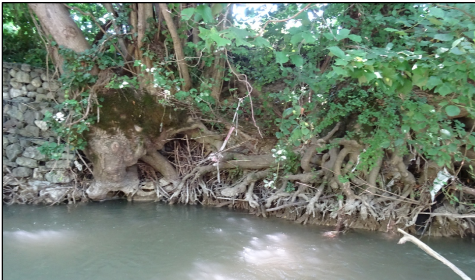
Photographie 30 : érosion importante des berges en extrémités d'ouvrages
