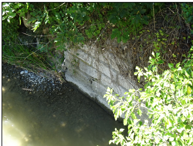
Photographie 39 : affouillement en pied d'ouvrage pk730
