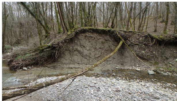
Zone d'érosion en rive droite, en face de la pente de la décharge
