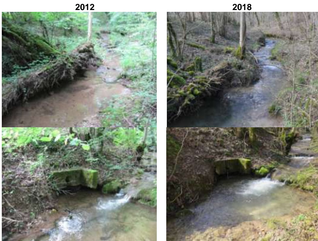
Affouillement et déchaussement d'un arbre (en haut) et affouillement d'un ouvrage (en bas) sur le ruisseau de Chanvière au niveau des anciennes lagunes de Feigères
