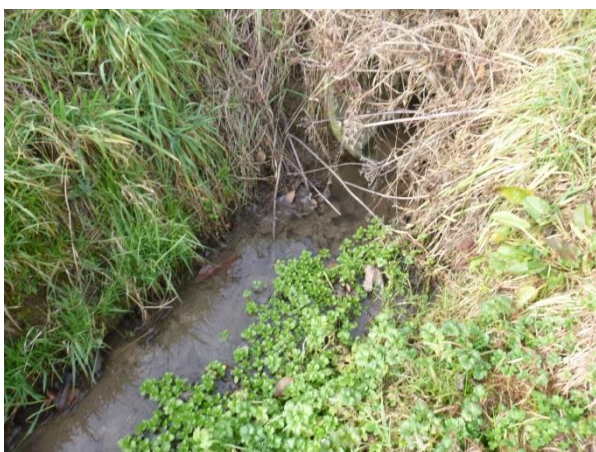
Rue du Four – Colmatage du lit du fossé récepteur du réseau pluvial, odeurs machine à laver
