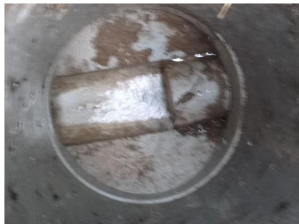
Boite de Branchement 97 Rue de la Corne – apport d'eaux claires, raccord non étanche
