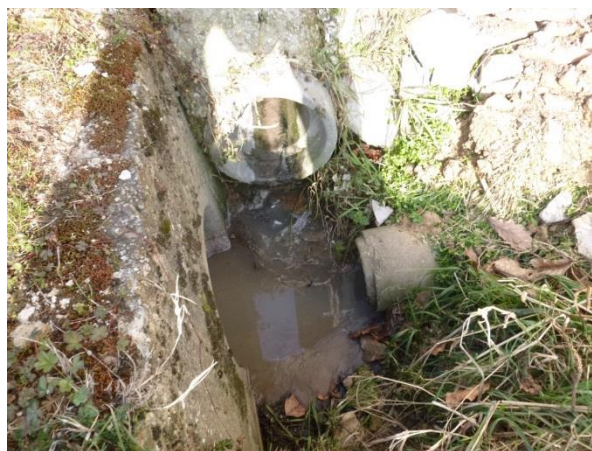
Intersection rue des gringons/des vendangeurs – rejets d'eaux vannes
