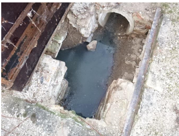
Regard 252 – Rue de Dijon – Présence d'eaux ménagères
