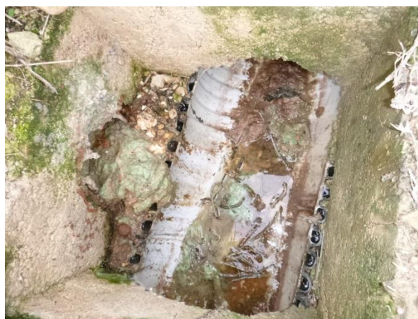
Rue de Vornay – Regard 368 – Rejet d'eaux vannes au réseau pluvial
