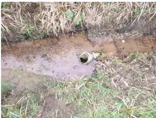
Branchement EU ayant vocation à capter l'eau du fossé Route de Vornay
