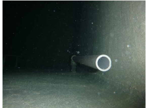
Alimentation de la fontaine depuis le réservoir
