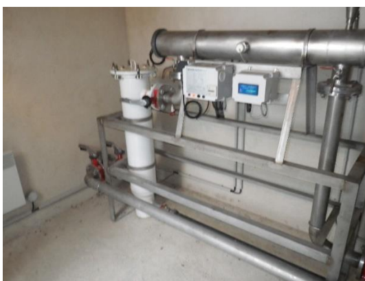
Traitement UV Rimon – Vue intérieure
