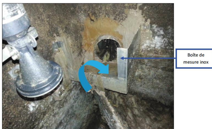
Figure 10 : Exemple de DO en canalisation
