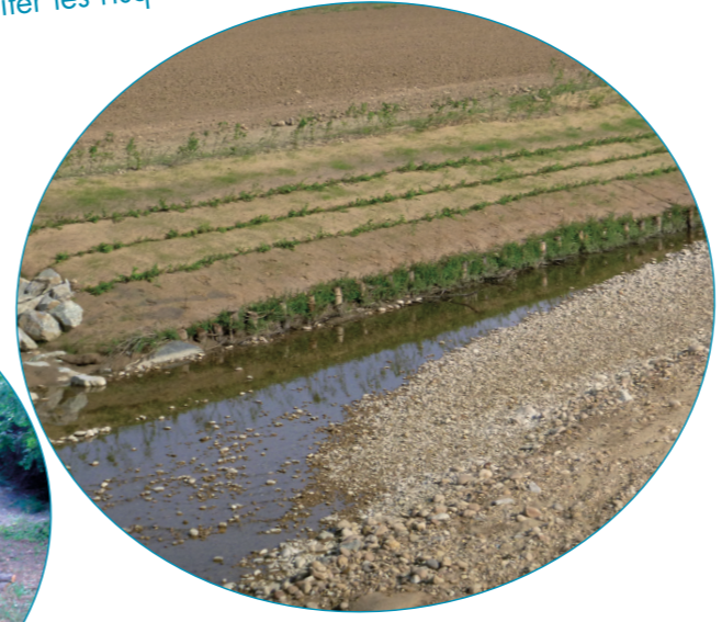
Aménagement de berges à Cabaret Neuf à Charmes-sur-l'Herbasse : technique végétale de confortement de berges par l'implantation de branches de saules et de pieux
