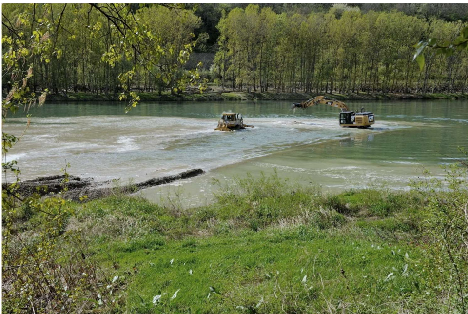
Vue du site de réinjection pendant le modelage de la masse de graviers
