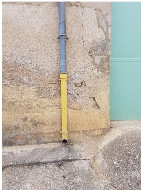
Figure 8 : Rejet d'eaux pluviales dans la rue du Chalon (source : Prolog Ingénierie)
