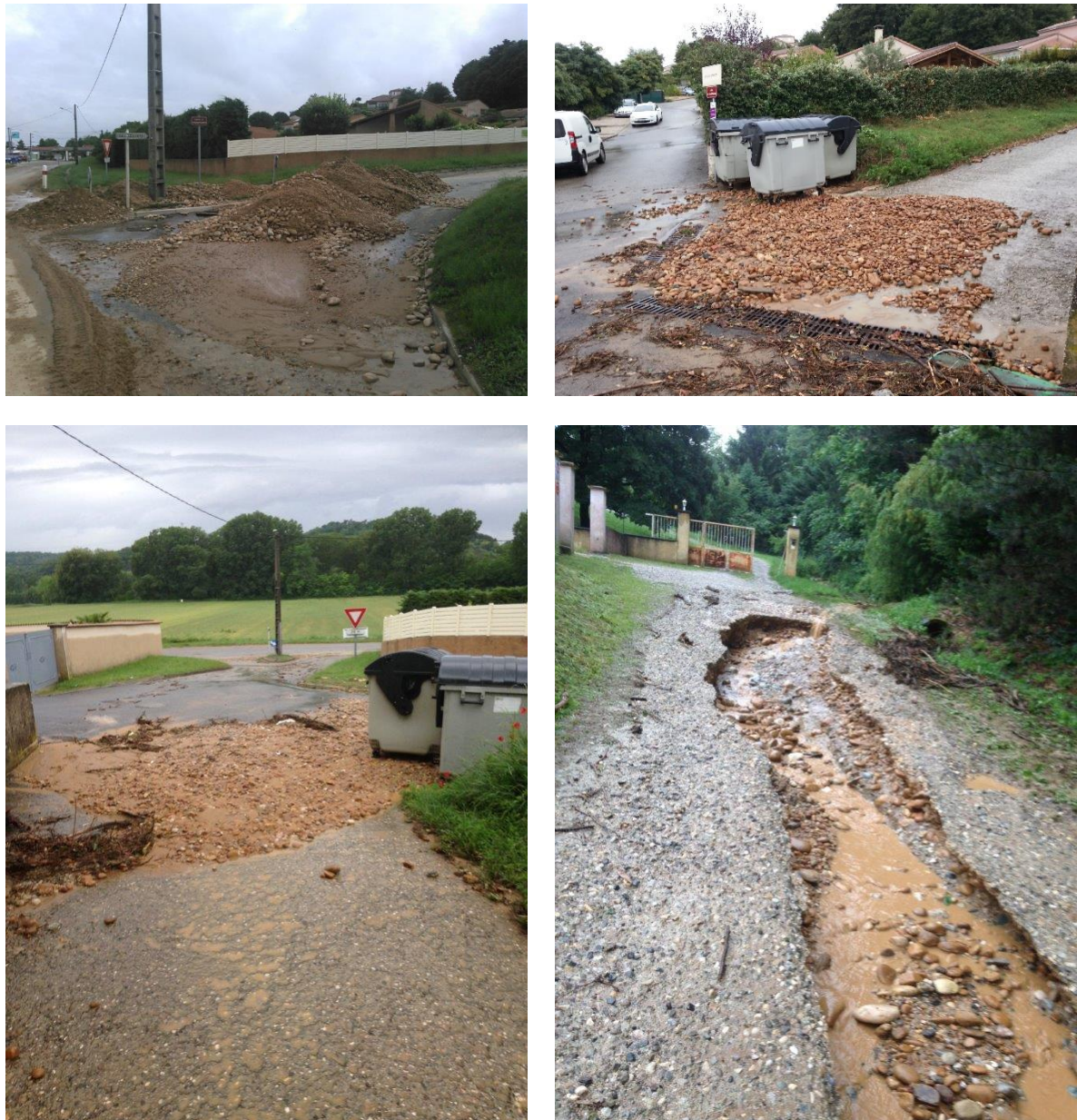
Figure 21 : Illustration des phénomènes de transport solide à l'œuvre sur les talwegs sec de la commune de Clérieux lors des épisodes pluvieux du 17/09/2015 et du 12/06/2018
