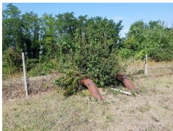
Poste de relevage en amont du centre-ville - lotissement Clerval (1/2)
