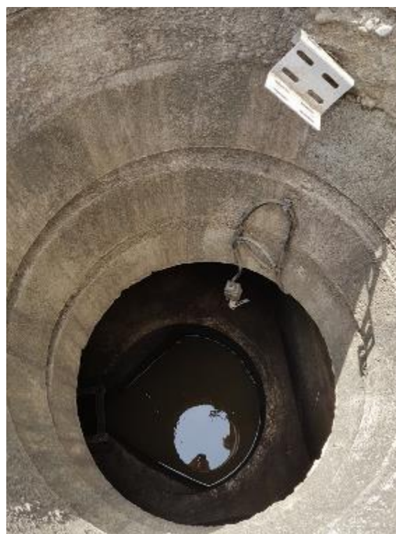
Poste de relevage en amont du centre-ville - lotissement Les Sables (2/2)
