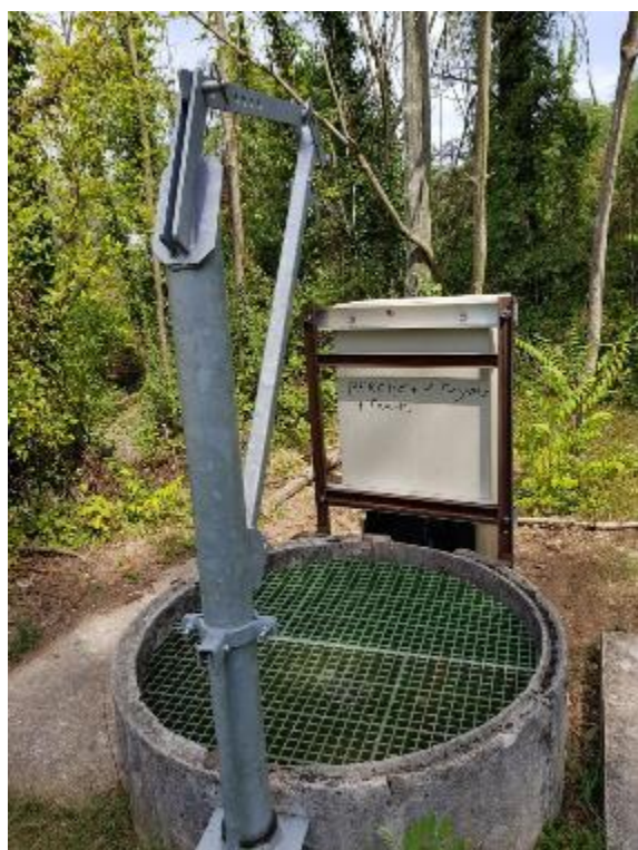
Poste de relevage en amont du centre-ville - lotissement Les Sables (1/2)
