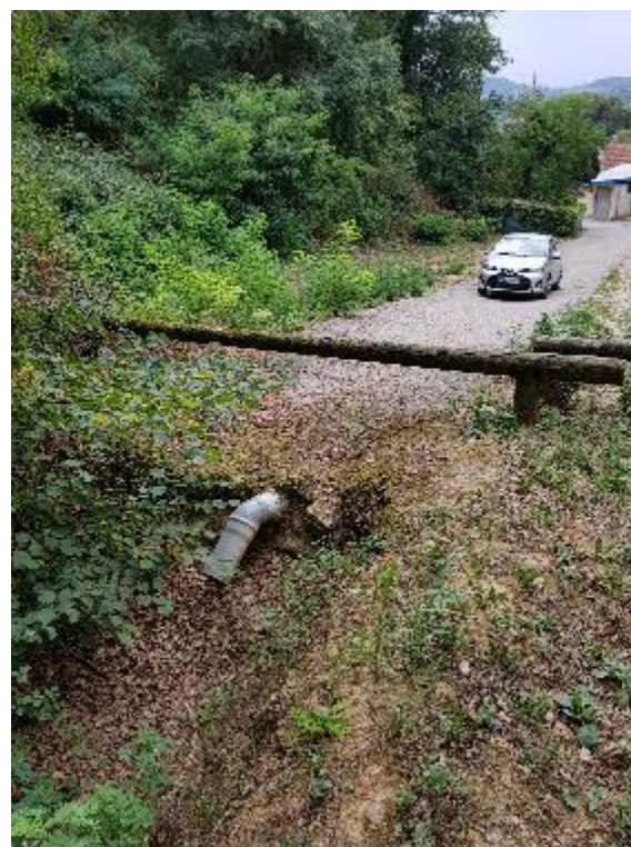
DN200 du Four Banal rejoignant le collecteur UN du centre-ville
