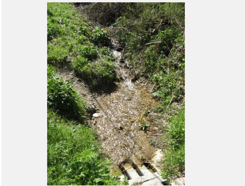
Vue de l'écoulement en aval le long de la route
