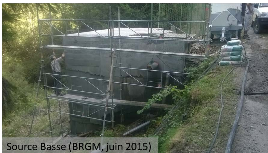
Figure 64. Vue des captages du syndicat Roquefeuilles-Espezel
