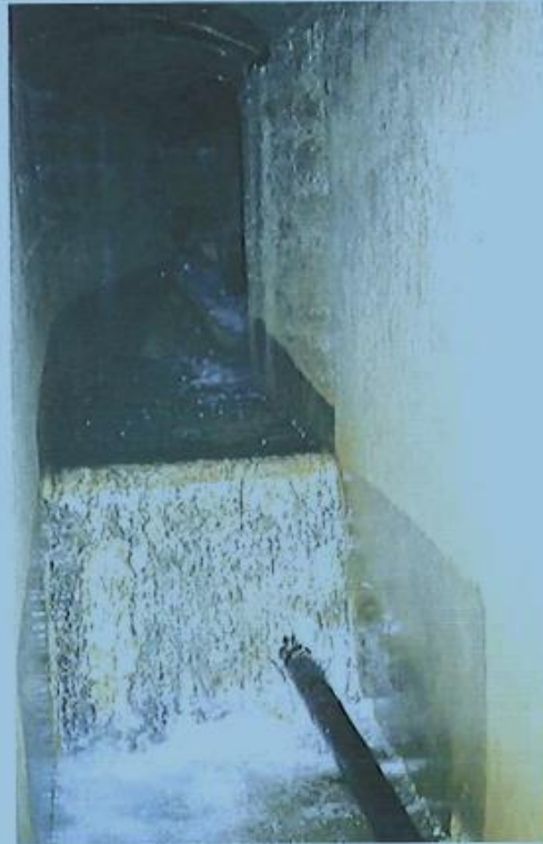
Photo 7 : Vue intérieure du captage de la Fajole
