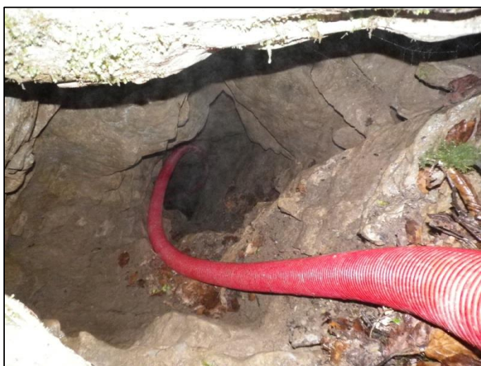
Illustration 122 : Vue de l'entrée du Barenc situé au dessus de la source des Adouxes (10882X0215/ADOUX) et vue partielle de l'équipement mis en place par le CG11 dans la cavité (BRGM, 04/04/2014).
