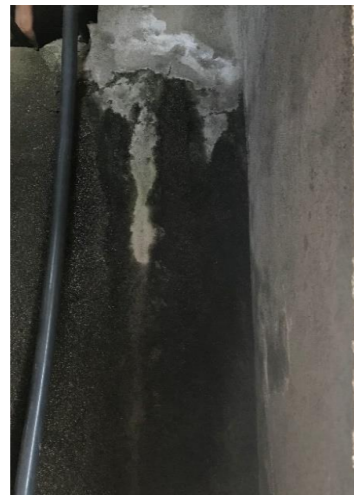
Etanchéité non assurée au sein du réservoir
