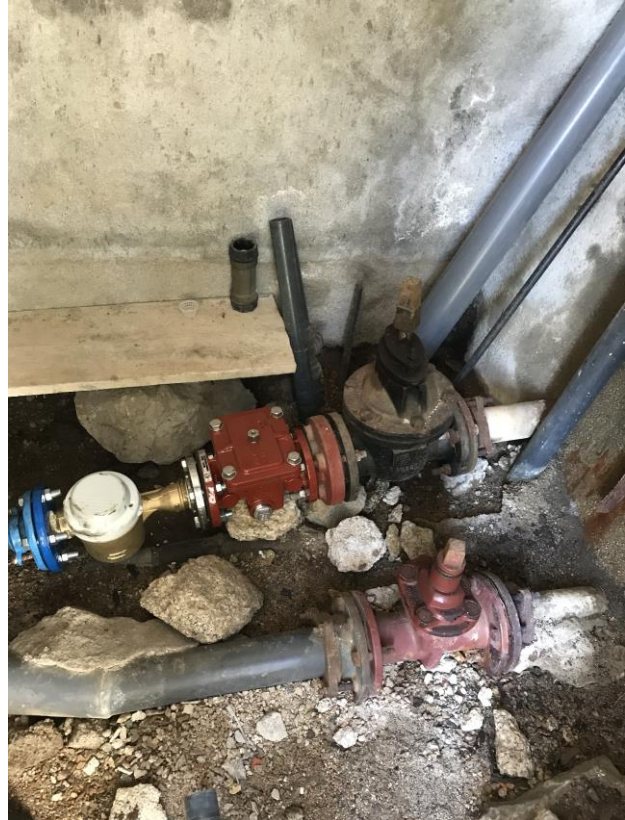
Figure 11 : Chambre des vannes du réservoir de Chiappa
