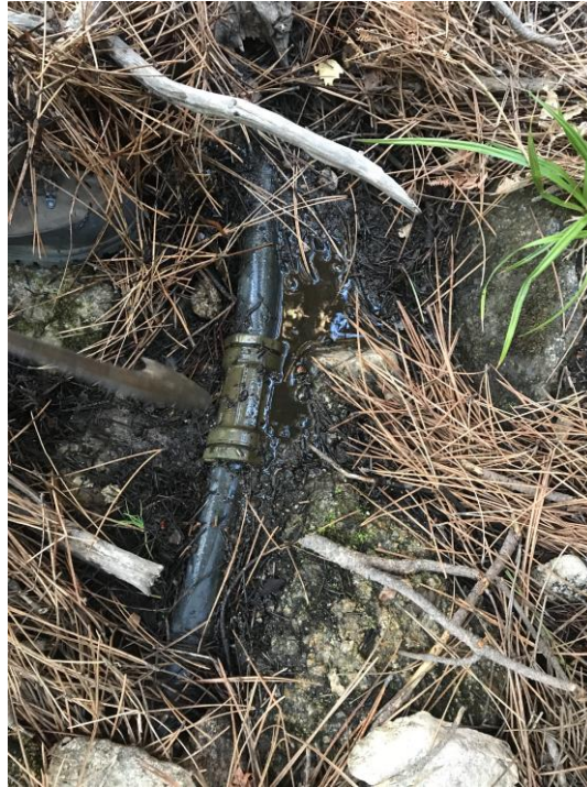
Figure 15 : Fuite sur canalisation d'adduction
