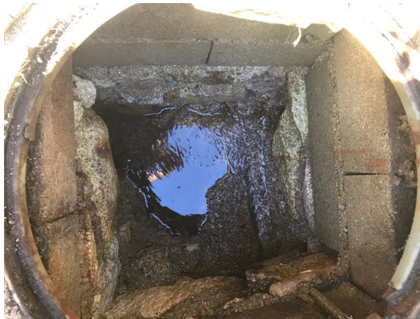
Figure 5 : Ouvrage de captage de la source de Smargine basse
