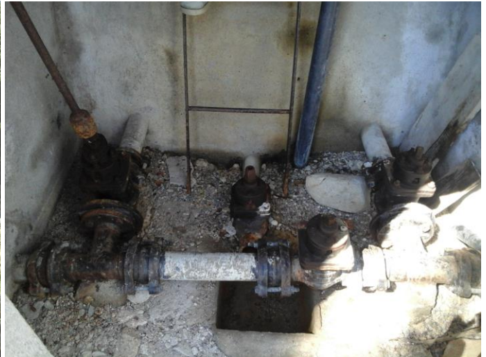
Figure 13 : Chambre des vannes du réservoir de Nivale
