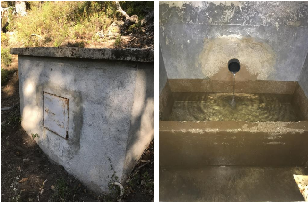
Figure 9 : Ouvrage de captage des sources de Frasselli
