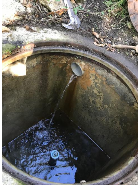
Figure 6 : Ouvrage de collecte de la source de Smargine basse
