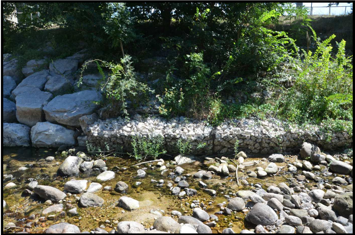
Photo 1: Aménagement en gabions stade de football de Jaujac
