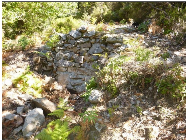
Photo 4 : Captage de FORCCIOLO, vue générale (TPAe, 21/09/2017)
