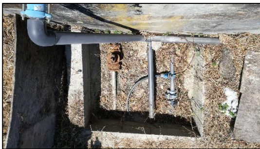
Photo 28 : Chambre des vannes du réservoir de POGGIOLO (TPAe, 15/06/2017)
