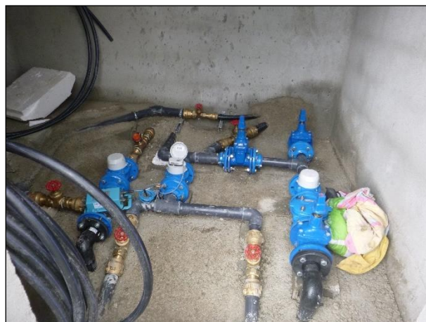
Photo 14 : Chambre des vannes de SANTA LUCIA DI MERCURIO (TPAe, 05/06/2018)
