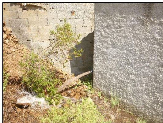
Photo 36 : Sortie de l'eau de lavage du filtre (TPAe, 15/06/2017)
