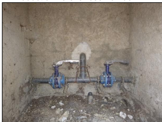
Photo 25 : Chambre des vannes pour la répartition de l'eau entre les réservoirs de POGGIOLO et PIEDIVALDO (TPAe, 15/06/2017)
