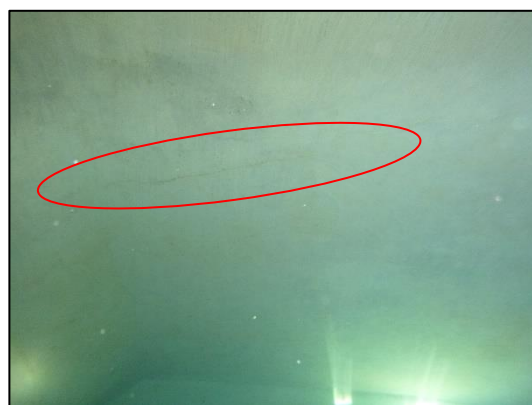
Photo 24 : Fissure à l'intérieur du réservoir 2 (TPAe, 15/06/2017)
