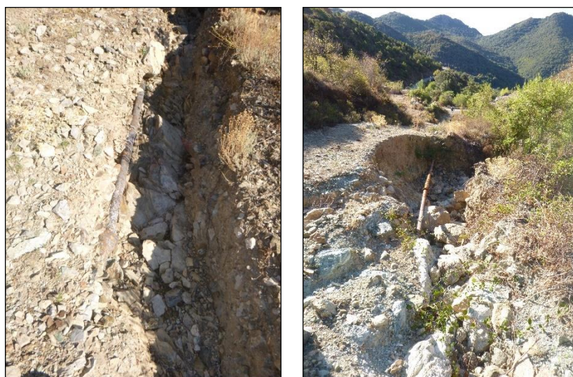
Photo 13 : Conduite d'adduction découverte (à gauche) et en aérien (à droite) suite à des ravinements (TPAe, 22/09/2017)
