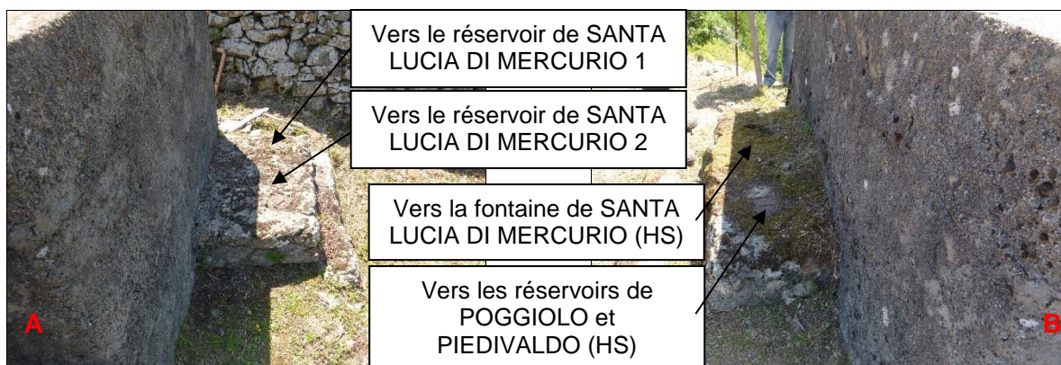
Photo 17 : Bouches à clé des vannes sur les conduites en sortie du regard de répartition de SANTA LUCIA DI MERCURIO (TPAe, 15/06/2017)
