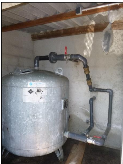
Photo 35 : Filtre à sable du réservoir de FIUMINALE (TPAe, 15/06/2017)
