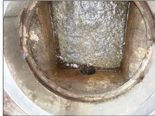
Photo 11 : Regard de collecte / décantation de FIUMINALE, sortie (TPAe, 21/09/2017)
