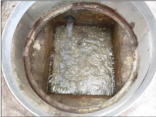
Photo 10 : Regard de collecte / décantation de FIUMINALE, entrée (TPAe, 21/09/2017)
