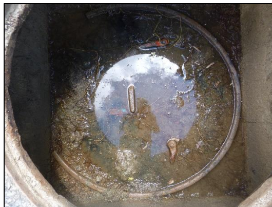
Photo 34 : Jeu de vannes permettant de by-passer le réservoir de PIEDIVALDO
