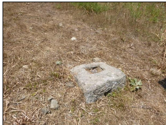
Photo 29 : Vanne de vidange du compartiment d'entrée dans le réservoir d POGGIOLO (TPAe, 15/06/2017)
