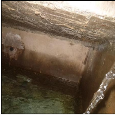
Photo 30 : Entrées de racines au niveau du plafond du réservoir de POGGIOLO (TPAe, 15/06/2017)
