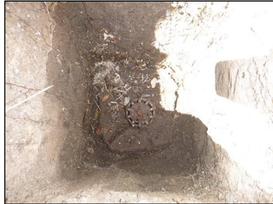
Photo 21 : Vanne de vidange du réservoir 1 (TPAe, 15/06/2017)
