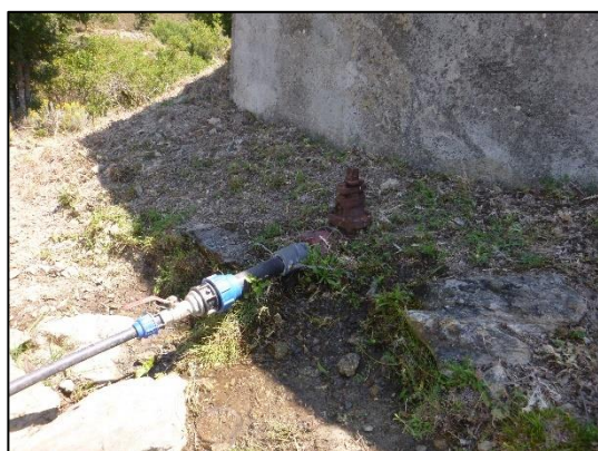
Photo 23 : Vanne de vidange du réservoir 2, raccordée à un branchement particulier (TPAe, 15/06/2017)
