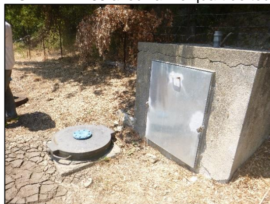
Photo 26 : Chambre des vannes et compartiment d'entrée dans le réservoir de POGGIOLO (TPAe, 15/06/2017)
