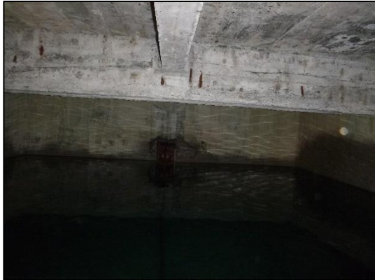
Photo 20 : Ferrillages apparents à l'intérieur du réservoir 1 (TPAe, 15/06/2017)
