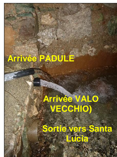
Photo 8 : Cabine de collecte, vue de l'intérieur
