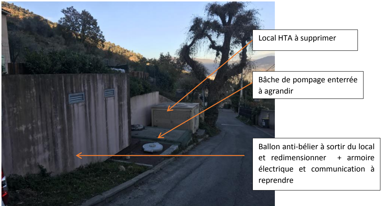
Figure 20 : Surpresseur de la Bachasse
