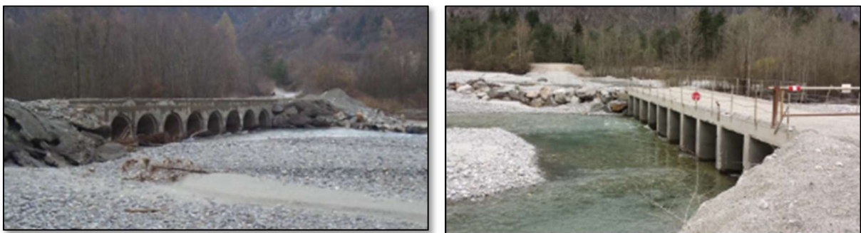
Figure 36 : Partie busée du seuil sur le Vénéon avant la crue de 2008 (à gauche) et après (à droite)
