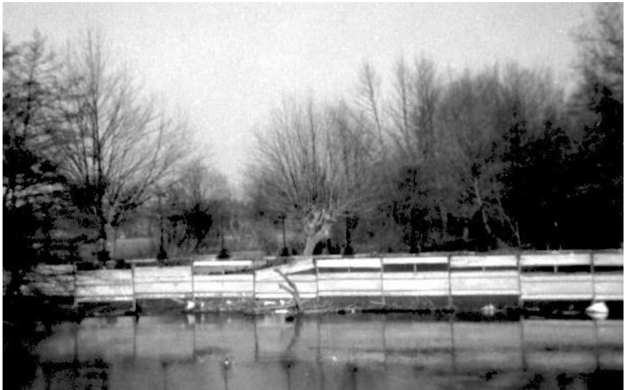
Vue du barrage vers la fin du XXème siècle (Vannes levées - Tabliers en très mauvais état)
