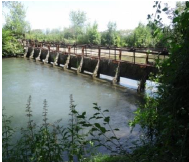
Vue sur la partie aval du barrage de Valobre, avec les vannes levées, lors de l'essai en juillet 2017
