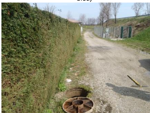
Regard à proximité des terrains de tennis (R813) (réseau inconnu)
