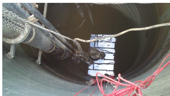
Intérieur PR4 – Les Sables – Eaux pluviales
