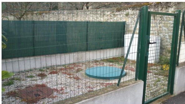
Extérieur PR3 –Supin – Eaux usées
