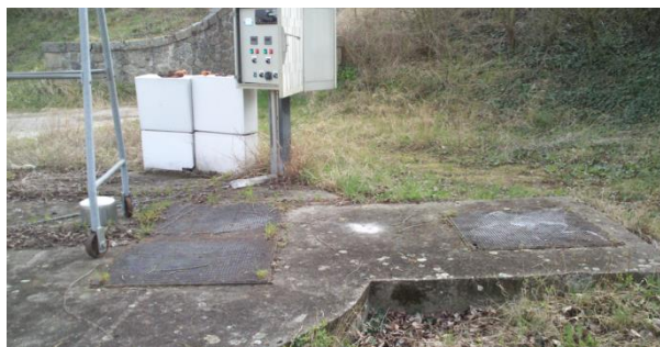
Extérieur PR6 - Verlieu – Eaux usées
