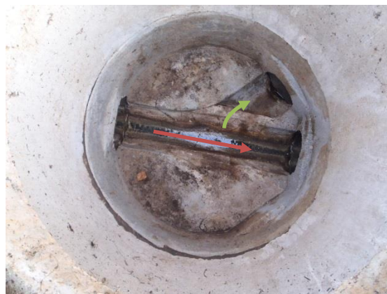
Intérieur DO8 – Amont STEP
