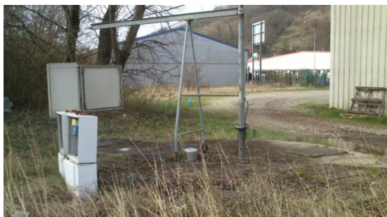
Extérieur PR6 - Verlieu – Eaux usées
