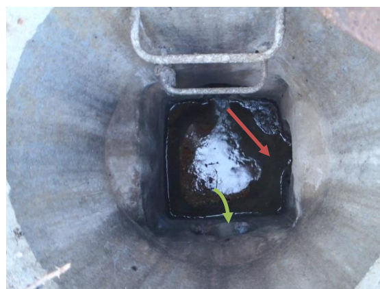
Intérieur DO9 – Amont STEP
