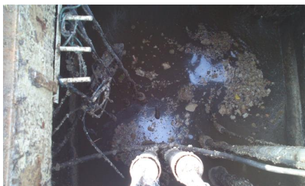
Intérieur PR8 - Grande Gorge – Eaux usées
