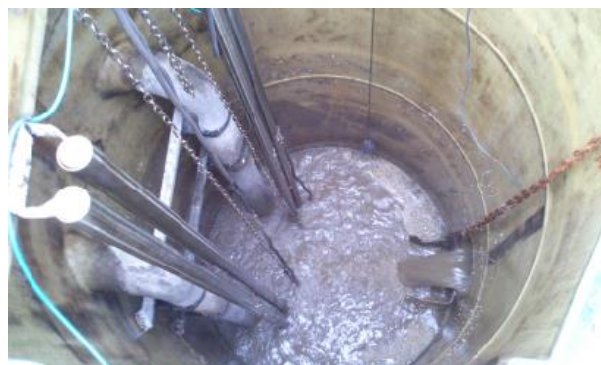
Vue intérieure – PR Jassoux Aval
