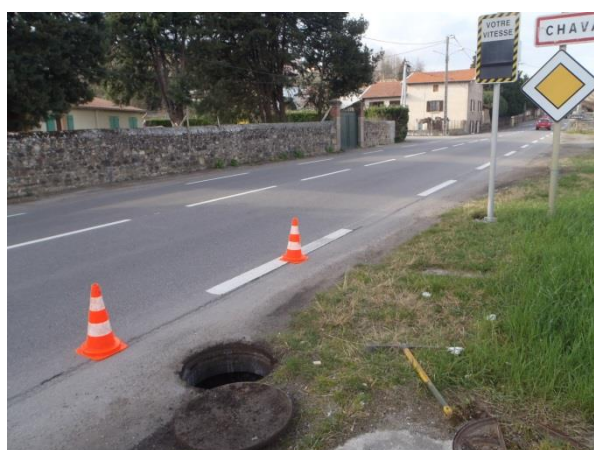
Extérieur DO7 – Amont PR Grande Gorge
