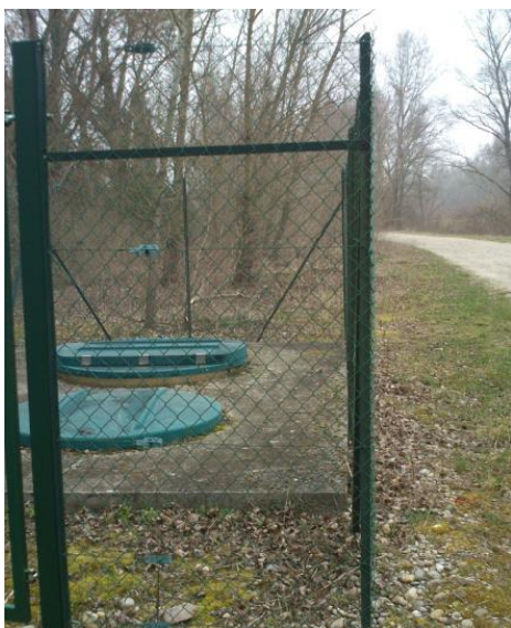
Vue extérieure – PR Jassoux Aval
