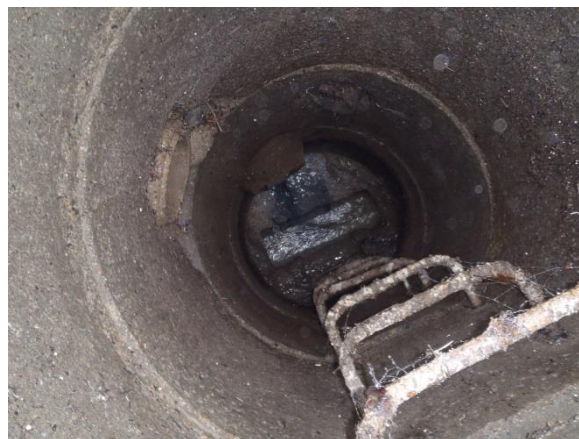
Branchement defectueux / Traces de mise en charge – Regard n°430 - Réseau eaux usées – Square du 11 novembre
