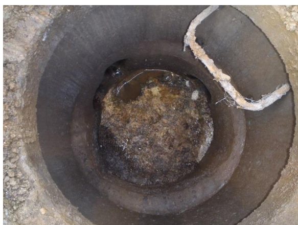
Absence de cunette / dépôts – Regard n°444 – Réseau eaux usées – D7 Chemin neuf
