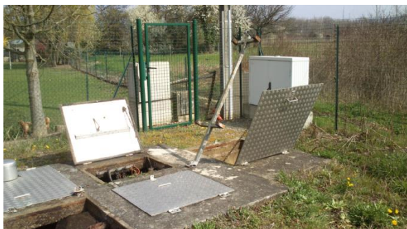
Extérieur PR2 – Grand Val – Eaux pluviales
