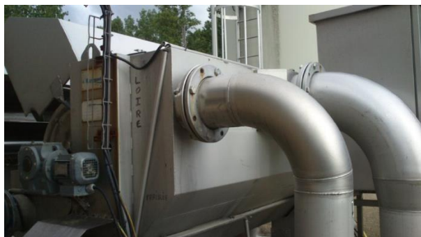
Prétraitements – Filtres à tambour
