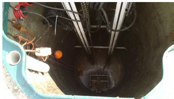
Intérieur PR1 – Grand Val – Eaux usées
