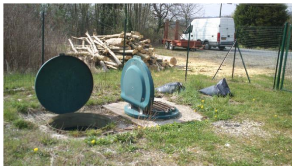
Extérieur PR1 – Grand Val – Eaux usées
