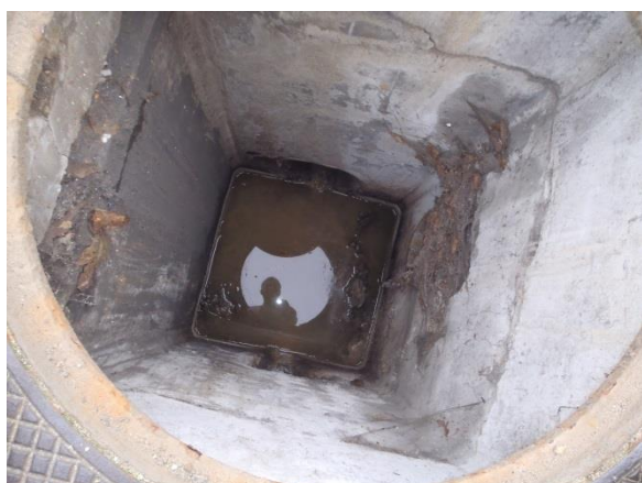
Absence de radier / stagnation d'effluents – Regard n°467– Réseau eaux usées – Départementale 1086
