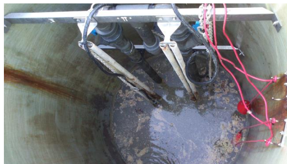
Vue intérieure – PR Grand Embuent
