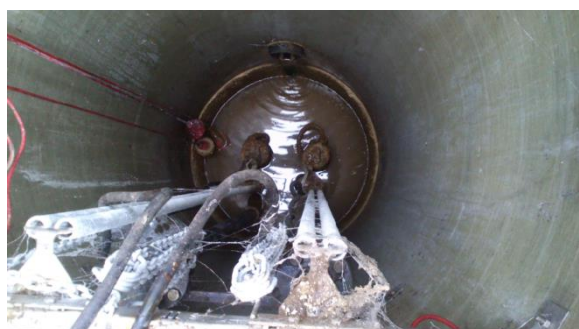
Intérieur PR9 – Chapois – Eaux usées
