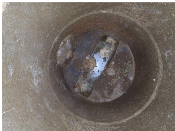
Traces EU – Regard n°112 – Réseau pluvial - Départementale 1086, Verlieux
