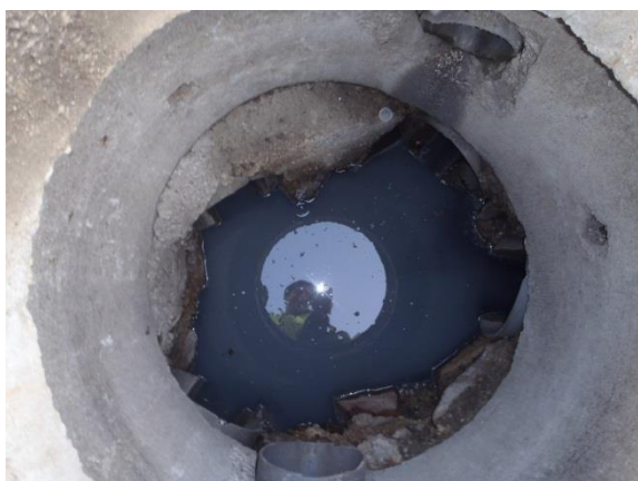
Absence de radier / cunette / stagnation d'effluent / branchements défectueux – Regard n°364 – Réseau unitaire - Départementale 1086
