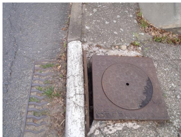
Avaloir non scellé – Rue du Chemin neuf – Réseau pluvial
