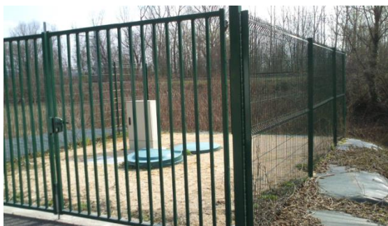
Extérieur PR7 – Chanson – Eaux usées
