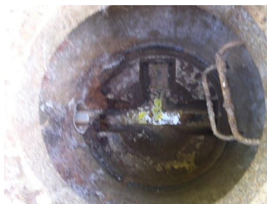
Racines – Regard n°1003 – Réseau eaux usées
