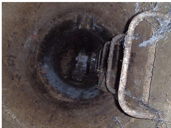
Dépôts / Stagnation d'effluent / Racines – Regard n°774 – Réseau eaux usées – Gymnase Départementale 7
