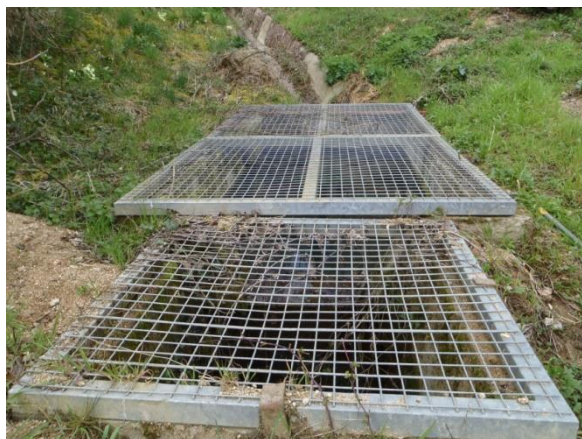
Fossé raccordé au réseau unitaire – Grande Gorge
