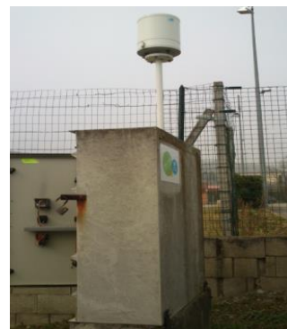
Armoire électrique et pluviomètre – PR Stade
