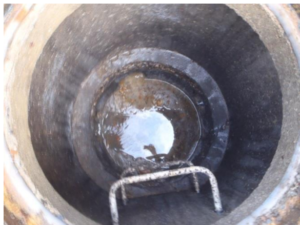
Dépôts/Absence de cunette/Racines – Regard n°3008 – Réseau unitaire
