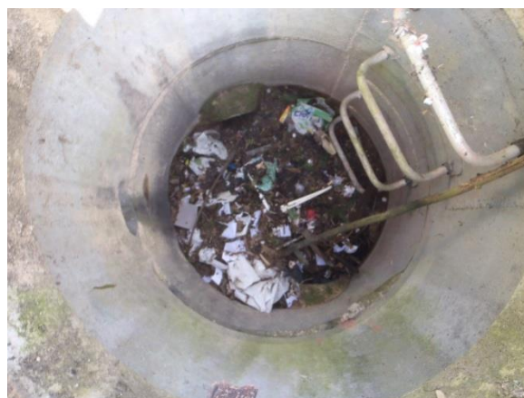
Dépôts – Regard n°2023 – Réseau pluvial
