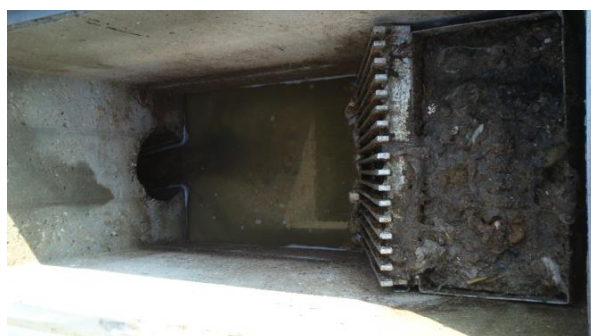
Canal d'entrée et Dégrillage
