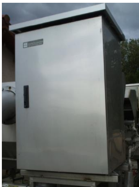
Préleveur en entrée de station
