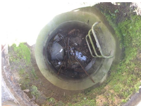
Radier dégradé – Regard n°2017 – Réseau pluvial
