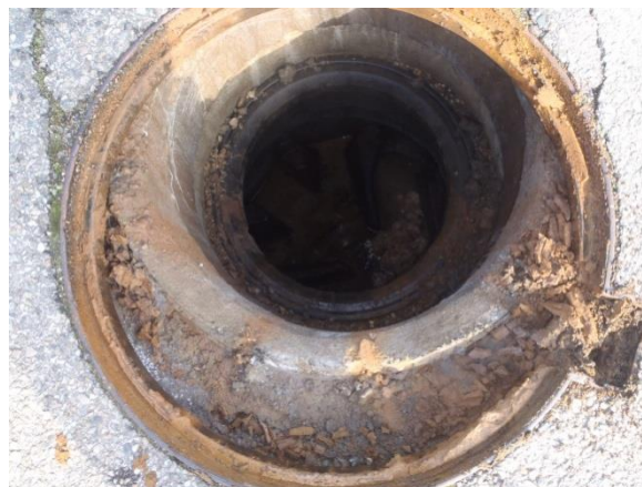
Cadre décalé – Regard n°789 – Réseau eaux usées – Chemin des Vessettes
