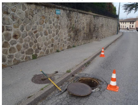
Affaissement tampon – Regard n°455 – Réseau eaux usées - D7 Chemin neuf
