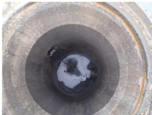
Effluent vinicole noir – Regard n°197 – Réseau eaux usées
