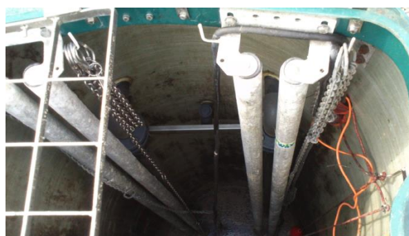
Intérieur PR5 – Marin – Eaux usées
