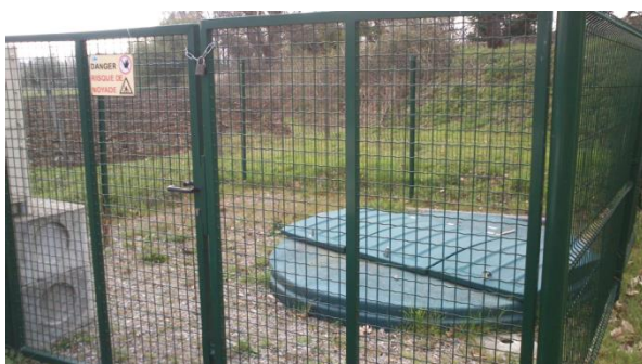
Extérieur PR4 – Les Sables – Eaux pluviales
