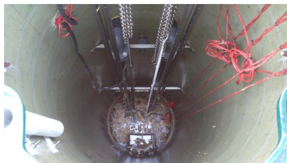
Intérieur PR7 – Chanson – Eaux usées
