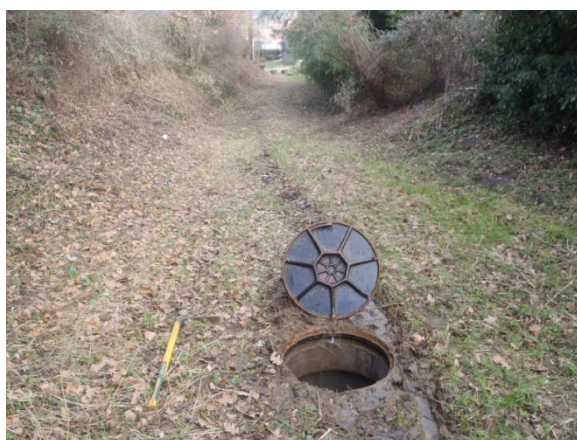
Apport d'eaux claires parasites par ruissellement au niveau du tampon - Regard n°178 – L'Ollagnère – Réseau eaux usées
