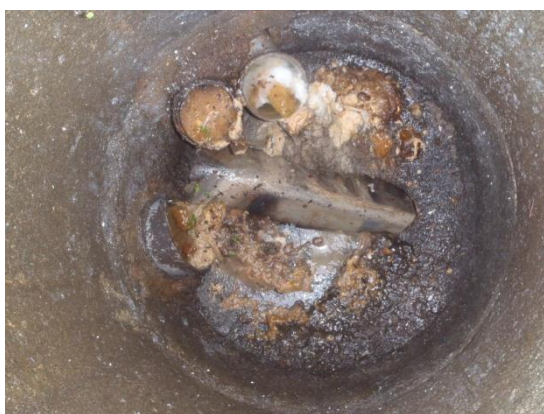
Dépôts importants - Regard n°121 – Place des Muriers – Réseau eaux usées
