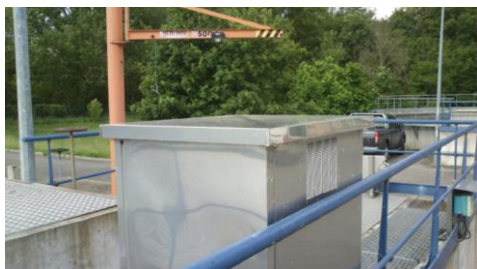
Préleveur en sortie de station
