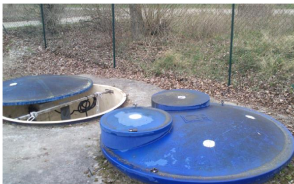
Vue extérieure – PR Jassoux pluvial
