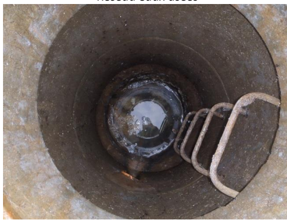
Stagnation d'effluent – Regard n°72 – Rue de Rampot - Réseau eaux usées
