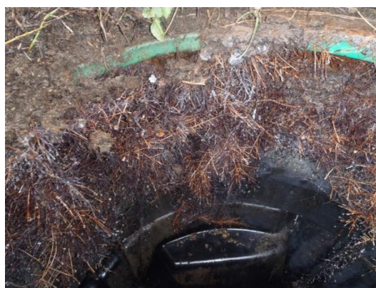
Racines - Regard n°153 – Impasse de l'Enclos – Réseau eaux usées
