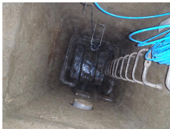
Regard 274 – Impasse des Bretteaux – Sonde de hauteur (Estimation du débit)
