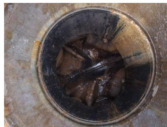
Infiltration - Regard n°91 – Route de Jeanraude – Réseau eaux usées
