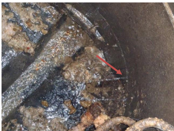
Infiltration – Regard n°10 – Rue des Granges - Réseau eaux usées
