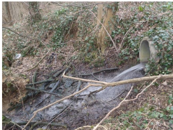
Rejet d'eaux usées par le DO2 par temps sec – Place du Belvédère
