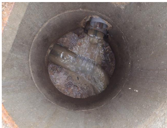
Jonction cunette/banquette non étanche – Regard n°83 – Place du Belvédère – Réseau eaux usées
