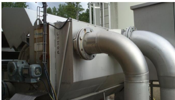
Prétraitements – Filtres à tambour
