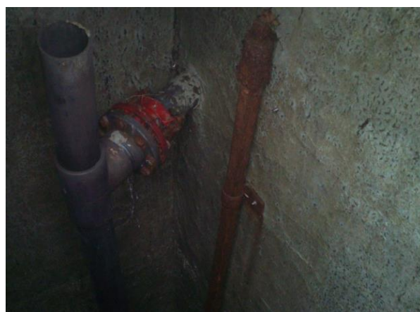
Arrivée d'une conduite en refoulement dans le DO
