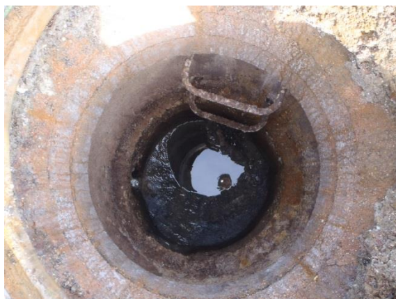
Dégradation H2S – Regard n°13 (Regard en aval du refoulement de Chauramond) – Rue des Granges - Réseau eaux usées
