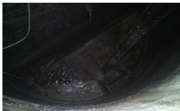
Vue intérieure – PR Jassoux Amont
