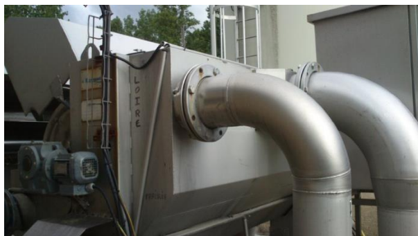
Prétraitements – Filtres à tambour
