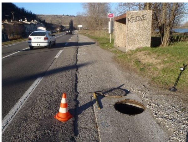
Vérin - Extérieur DO1 Pontcin
