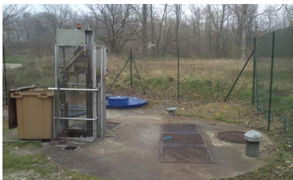
Vue extérieure – PR Jassoux Amont
