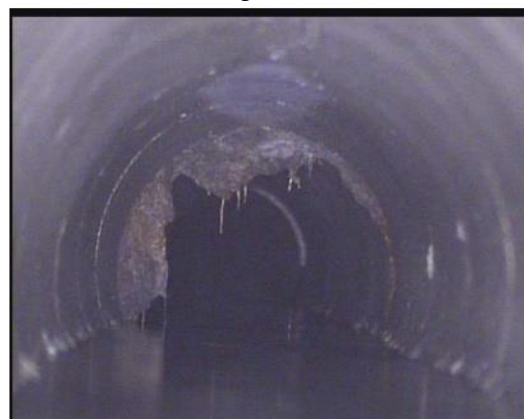
Vérin - Limite communale entre Vérin et Saint-Michel entre les regards 270 et 271
