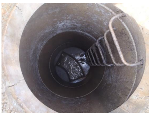
Couronne fissurée – Regard n°39 – Chavanay
