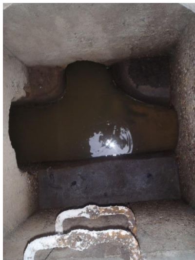
Stagnation d'effluent – Regard n°1 – Réseau eaux usées – Rue du Grand Port
