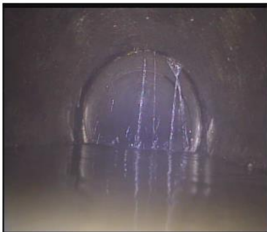
Saint-Michel-sur-Rhône - Infiltration en Amont du regard 46
