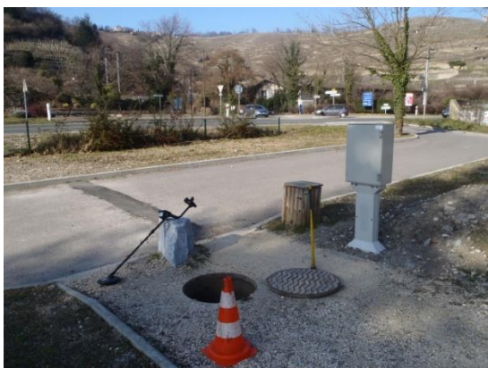
Regard 81 – Via Rhône – Regard du réseau syndical équipé d'une sonde de hauteur
