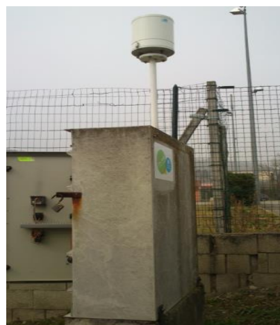
Armoire électrique et pluviomètre – PR Stade
