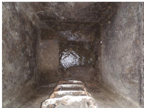
Racine/Radier dégradé/Dégradation H2S – Regard n°19 – Réseau eaux usées – Jardin de l'Hôtel Beau Rivage
