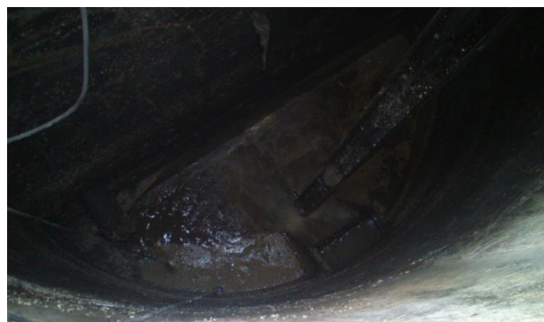
Vue intérieure – PR Jassoux Amont
