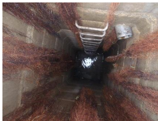
Regard à proximité des terrains de tennis (R813) (réseau inconnu)
