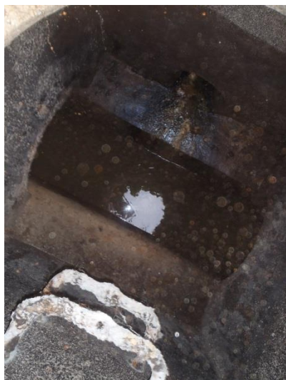
Dégradation H2S – Regard n°8 – Réseau eaux usées – Ruelle des Terreaux
