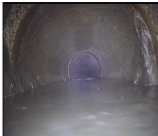
Saint-Michel-sur-Rhône - Infiltration en Aval du regard 46
