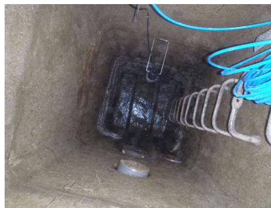
Regard 274 – Impasse des Bretteaux – Sonde de hauteur (Estimation du débit)
