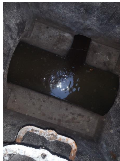
Dépôts / Traces de mise en charge – Regard n°5 – Réseau eaux usées – Rue du Grand Port
