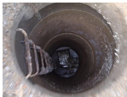
Traces de mise en charge – Regard n°41 – Chavanay
