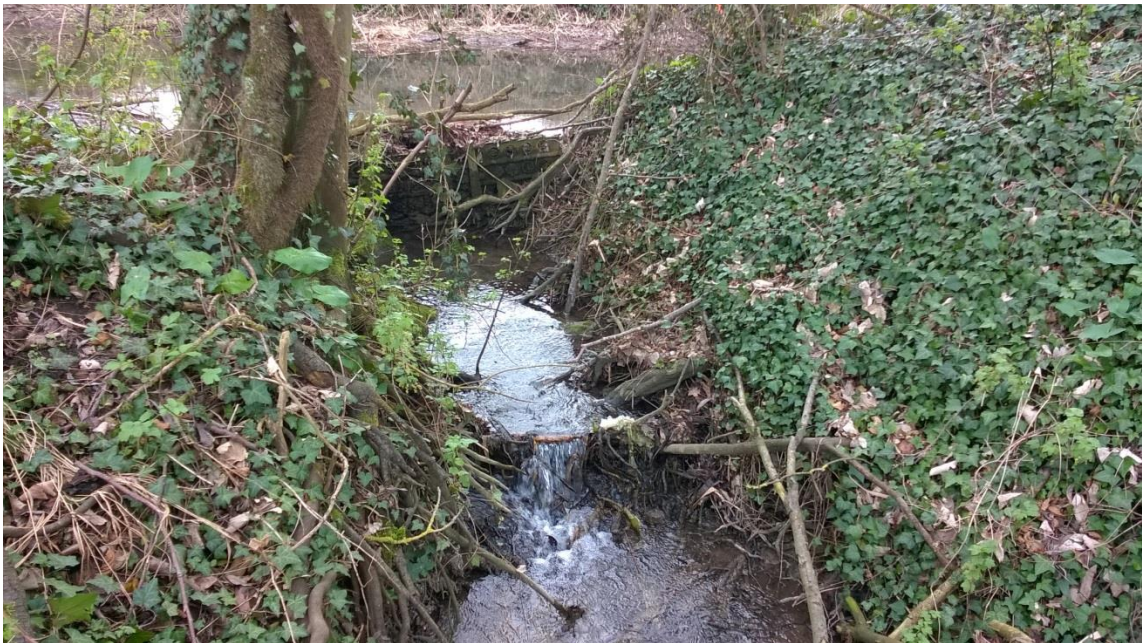
Fig. 12. Brèche – Côté amont
