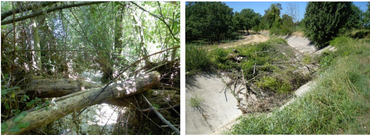
Figure 35 : exemple de bois morts sur le Bessey
