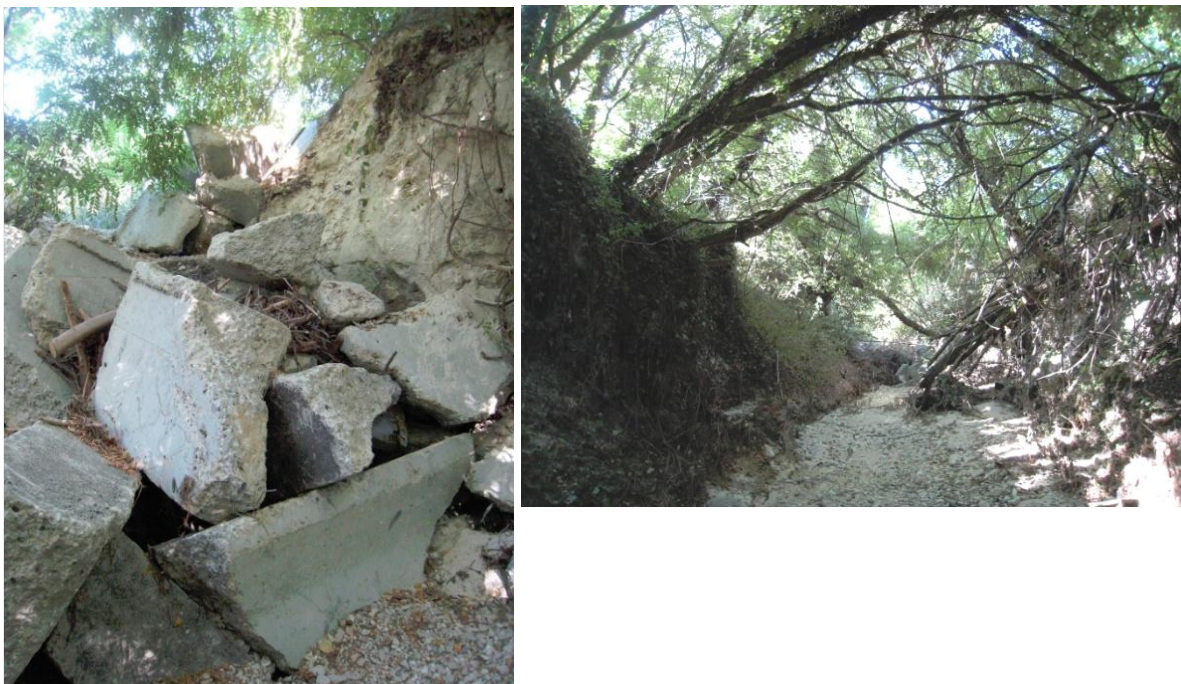
Figure 36 : érosions de berge traitées avec des blocs de béton et arbres affouillés sur le Bessey
