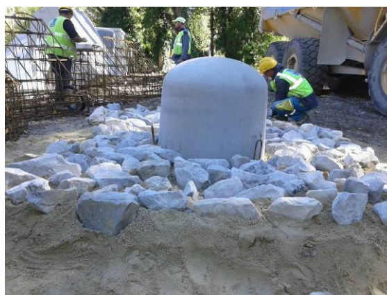
Gauche: Raccord des plots béton - fondations de l'ouvrage Droite: Rugosité de fond (planche d'essai)
