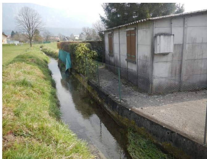
Traces d'humidité sur l'habitation RG
