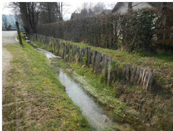
Anciennes protections (pieux en bois) de pieds berge (en mauvais état) – points bas
