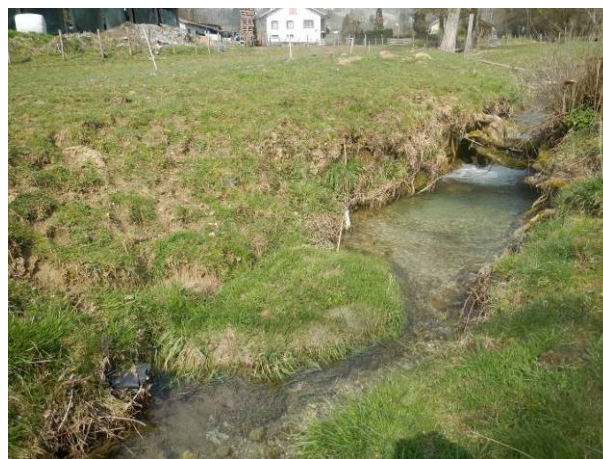
Traces d'érosion, de glissement de berge
