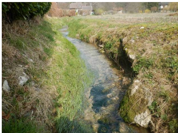
Anciennes protections de pieds berge (en mauvais état)
