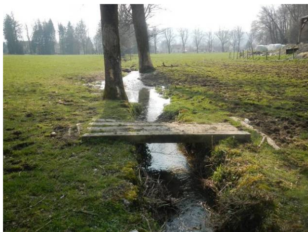
Passerelle en bois pouvant favoriser des embâcles
