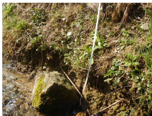
Pierre écroulée (ancienne protection de pieds berge)
