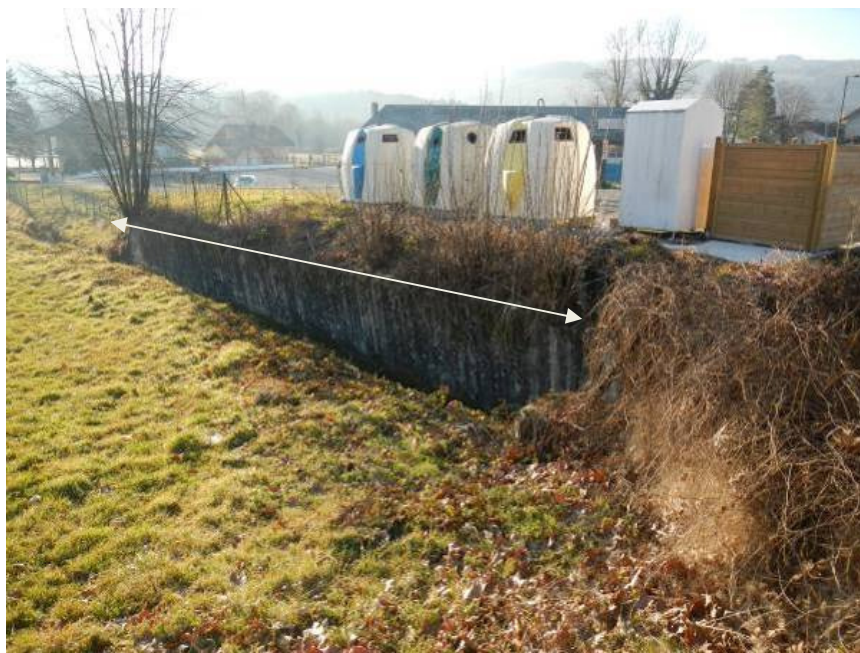
Figure 59 : Mur dégradé en rive droite en aval de la RD1006
