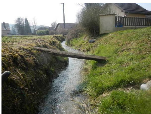
Passerelle pouvant faire obstacle (embâcle)
