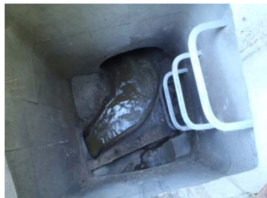
DO du Gornay (amont PR) Suintement d'eaux usées par temps sec au niveau de la surverse
