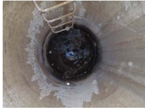
Rue des Transporteurs – ZA des Platières Absence de cunette, dépôts (regard MOR_05)
