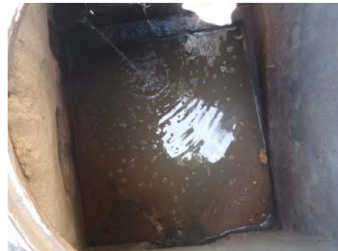
Route de Saint-Vincent / Chemin du Gorgée Stagnation d'effluents, dépôts (regard SLA_10)
