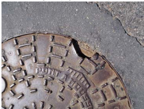
Rue Frédéric Monier – ZA des Platières Tampon cassé (regard MOR_07)
