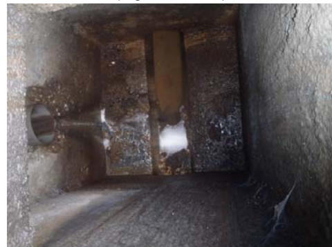
Avenue du Général Brosset Cailloux dans la cunette, stagnation d'effluents (regard ORL_20)
