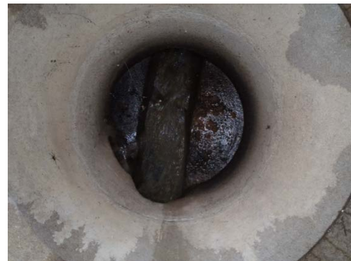
Chemin du Pré Rond Radier dégradé : fissures, cassures (regard MON_03)
