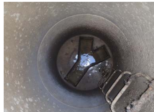
Saint-Laurent-d'Agnly – Place Neuve Regard SLA_07 : Dépôts de graisses dans la cunette
