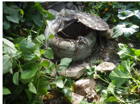
Mise en charge / débordement
