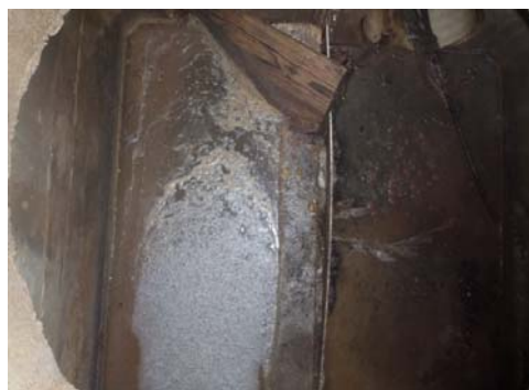
DO Chemin du Gotet Etanchéité entre la lame métallique et le béton à reprendre (suintement continu d'effluents sous la lame métallique)
