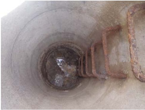
ZI de Chaponost – Route des Collonges Regard ZIC_08 : importants dépôts de graisses, réseau obstrué
