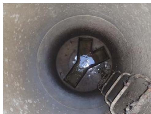
Place Neuve Traces de mise en charge, dépôts de graisses dans la cunette (regard SLA_07)
