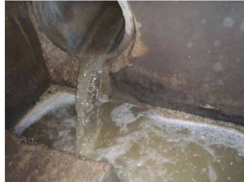
DO Mini-golf – La Trillonnière Radier dégradé, dépôts et stagnation d'effluents
