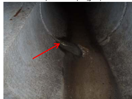
DO Chemin de la Rivière Infiltration dans la jointure du béton
