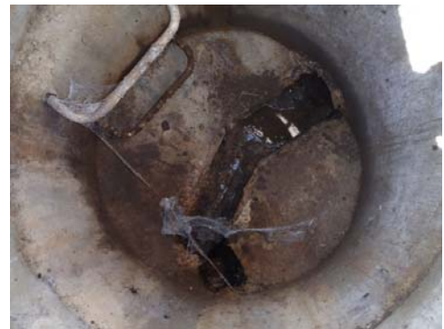
Lieu-dit Le Vernay Infiltration sur la cheminée (regard MOR_08)
