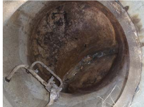
Chemin de la Combat Réduction de section et traces de mise en charge (regard ORL_03)
