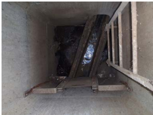
DO Mère Elise Rivet Cunette fendue, suintement d'eaux usées dans la surverse
