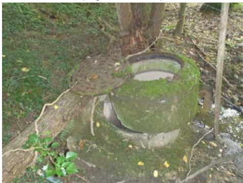
Aval Les Curallières – le long du Merdanson Virole décalée et trace de surverse (regard ORL_08)
