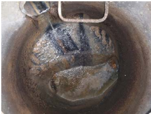
Route de Crémière / Route de Prapin Réduction de section, sortie partiellement bouchée et présence de racines sur la cheminée (regard SLA_08)
