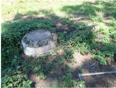
Amont immédiat du PR de La Côte Traces de surverse autour du regard, scellement du tampon dégradé (regard MOR_01)
