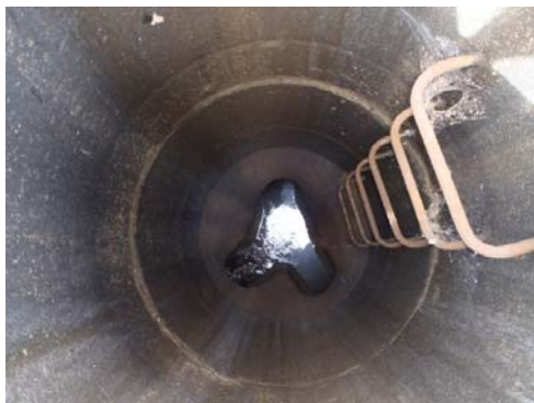
Montagny – Allée des Erables/Allée des Noisetiers Regard MON_17 : effluent huileux
