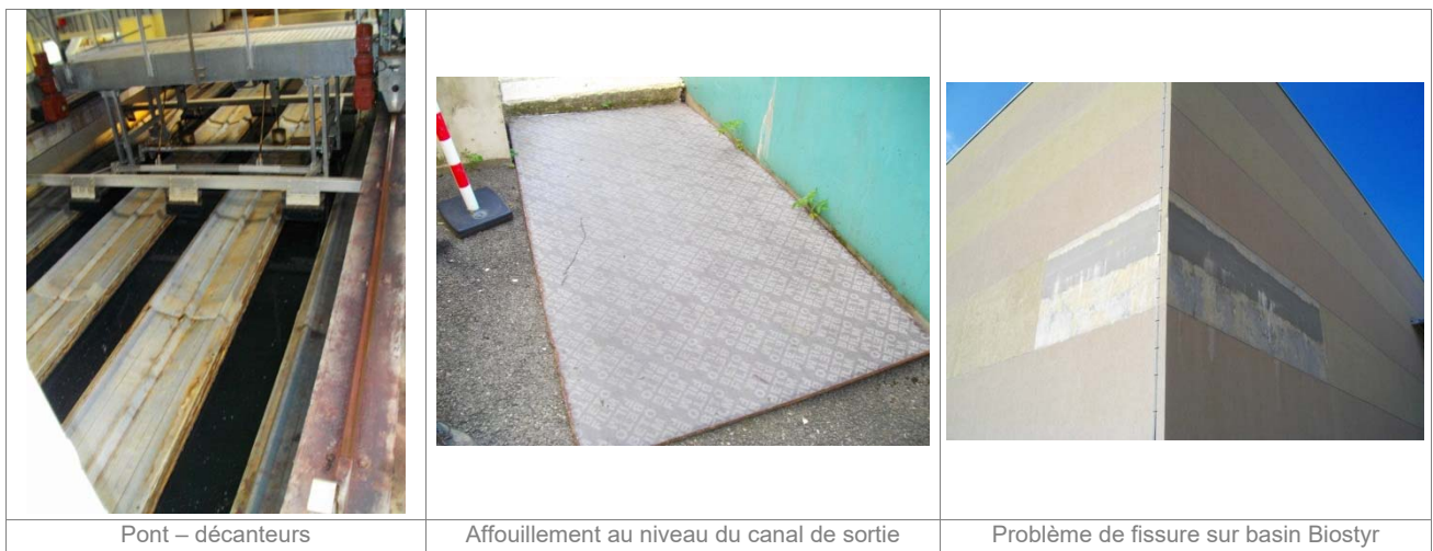
Figure 25 : Etat des installations – zones problématiques
