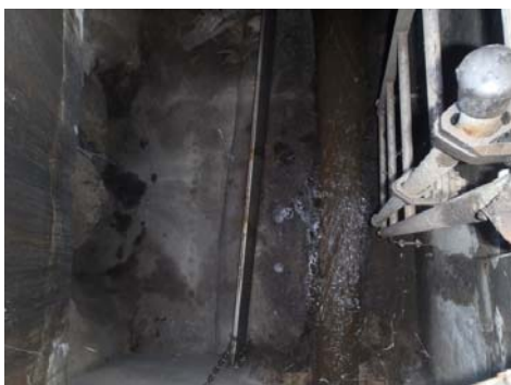
DO Route des Sept Chemins Etanchéité entre la lame métallique et le béton à reprendre
