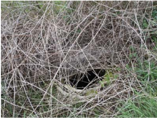
Route de Mornant Cadre et tampon décalés, tampon ouvert avant notre passage (regard CHN_07)
