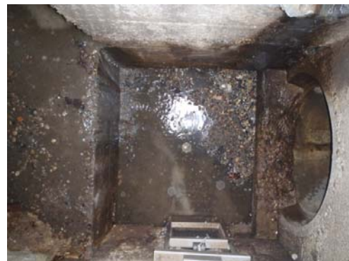
DO Route de Ravel / Route du Pré Lacour Beaucoup de graviers, crête dégradée et non uniforme
