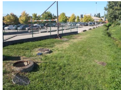
DO Route d'Irigny Tampon non adapté (grille)
