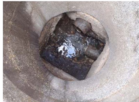
Rue Guillaume Privas Infiltration, absence de radier et de cunette, virole dégradée et branchements défectueux (regard ECH_14)
