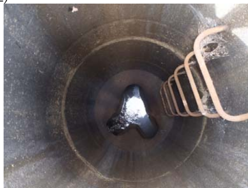
Allée des Noisetiers Effluent d'aspect huileux (regard MON_17)
