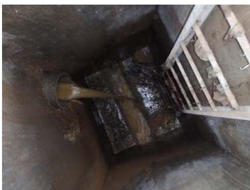
Rue du Bas Clair Traces de mise en charge (regard SLA_03)
