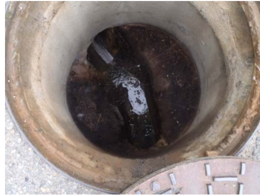
DO Chemin des Garennes / RD 34 Radier dégradé (fissures, cassures)
