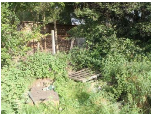
DO Site de l'ancienne STEP Pas de tampon, seulement une palette posée sur regard
