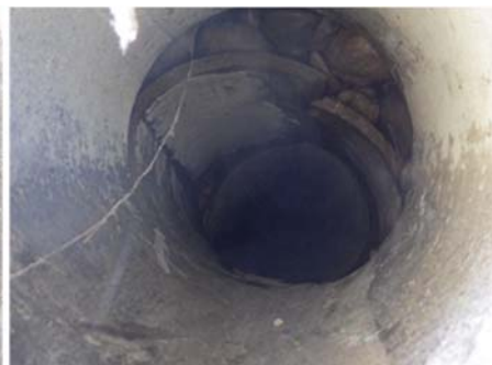
Effondrement sur collecteur
