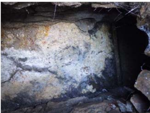
Givors – amont PR Neuvessele Dépôts, graisses, mise en charge
