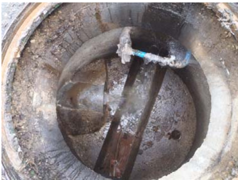
Lotissement des Tourterelles/ Rue des Anciens Combattants Réduction de section, traces de mise en charge (regard MON_12)
