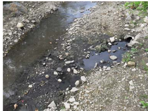
Collecteur dégradé et rejet pollué
