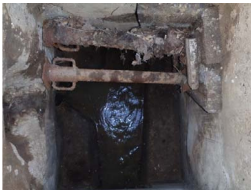
Rue du Général de Gaulle/ Rue Diot Présence d'un étai, traces de mise en charge (regard BRI_08)
