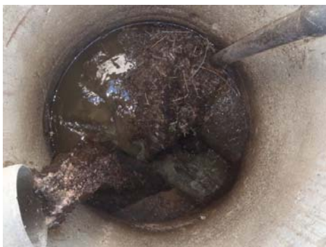
Route des Varennes – ZA des Platières Réseau pratiquement obstrué par la présence de racines et de dépôts (regard CHY_17)
