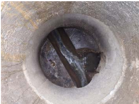
Rue du Coin / Lotissement Beauversant Branchement défectueux (regard ECH_07)
