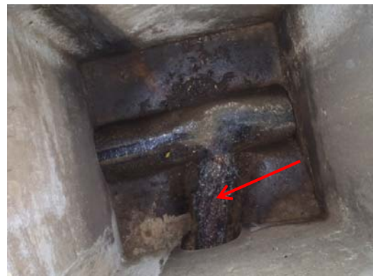
Chemin de la Côte/Chemin du Cantonniau Beaucoup d'ECP sur une courte antenne (regard BRI_09)
