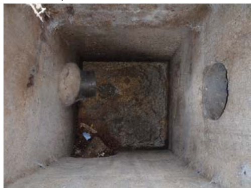
DO Rue des Ronzières Cheminée cassée et fissurée, présence de graisses et de racines
