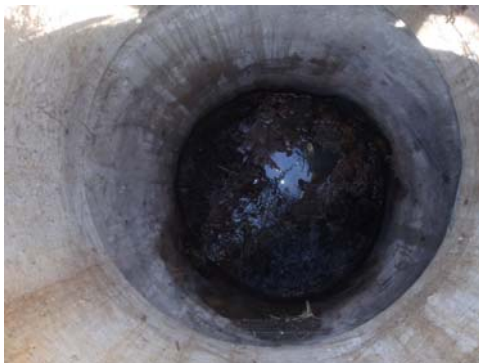
Route Départementale 42 – ZA de la Ronze Absence de cunette, infiltrations (regard TAL_12)
