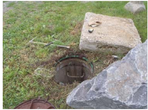
Amont PR du Stade Charnière du tampon cassée (regard MOR_15)
