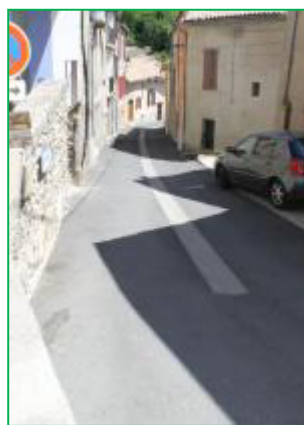
Enrobé récent avec absence de bordure limitant les joints propices à l'arrivée de la végétation. Agir en préventif pour supprimer le dépôt de matière organique.
