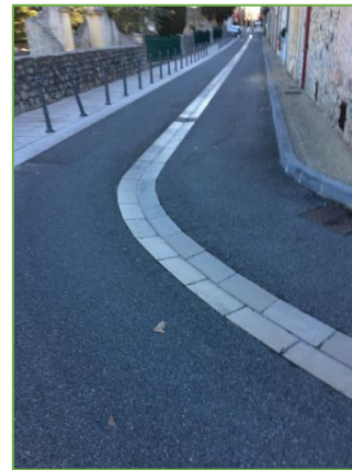
Enrobé récent avec absence de bordure limitant les joints propices à l'arrivée de la végétation. Agir en préventif pour supprimer le dépôt de matière organique.
