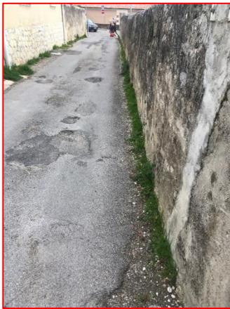
Chemin vieillissant propice à la levée de végétation
