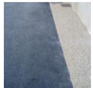
Absence de bordure démarcation de la zone piétonne et voiture par un changement de matériaux et de couleur.
