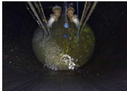
Vue intérieure du poste de Loché
