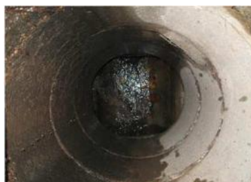
Regard EP (ouvert pour contrôle ponctuel)
