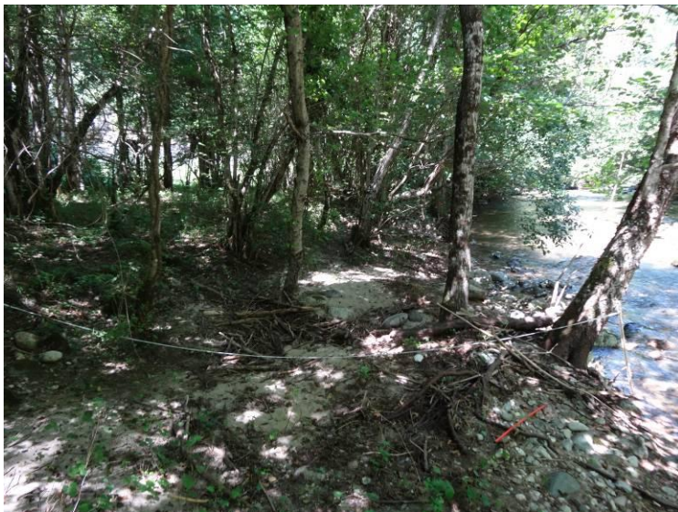
Fig 11 : berge érodée et dépôts de sable
