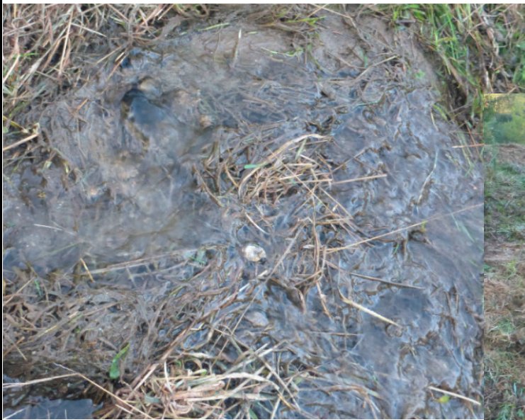
Resurgence en RD amont de la retenue
