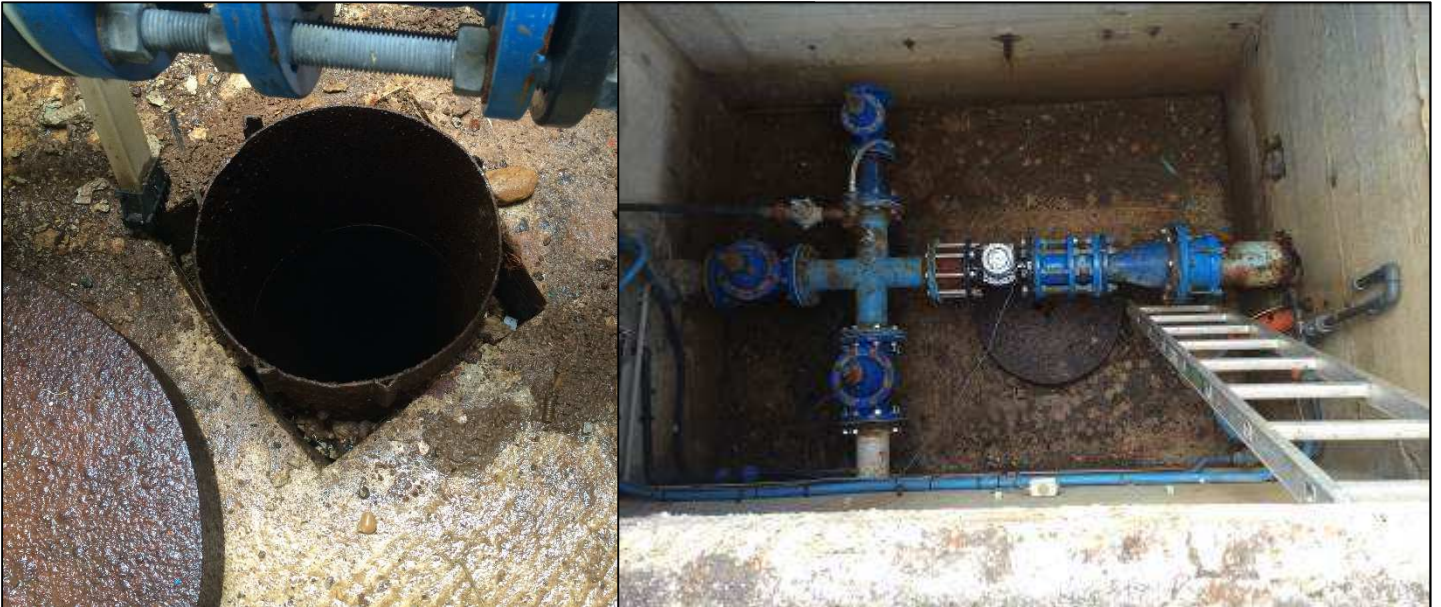
Figure 2 : Photographie du captage « Bielles 0 »
