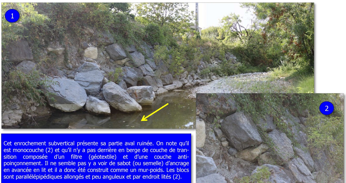
Figure 24 : En haut → enrochement en aval du pont à créneaux partiellement ruiné ; en bas détail de la partie ruinée.
