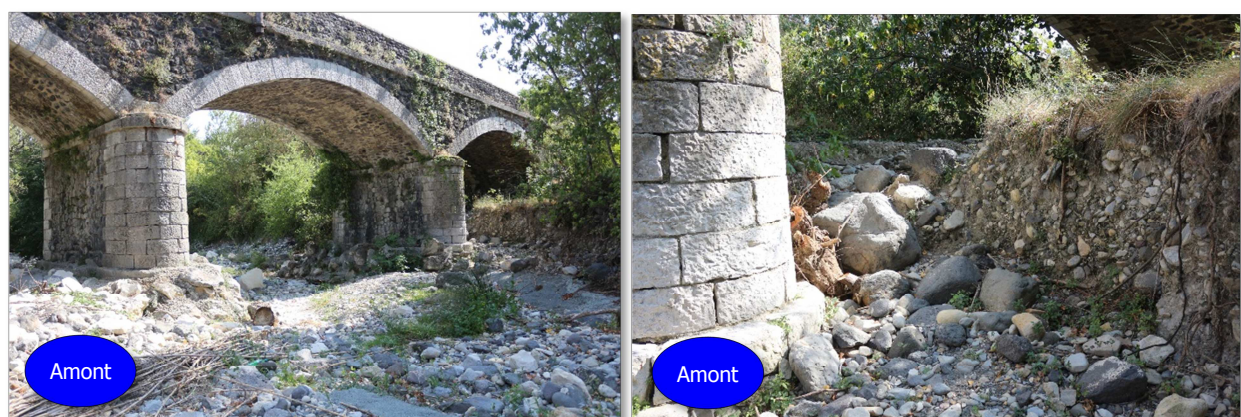
Figure 20 : à gauche → massifs de renforts de P1 et P2, on note T3 obstruée partiellement ; à droite → travée T3 obstruée et l'érosion générée par le passage du Frayol en crue.
