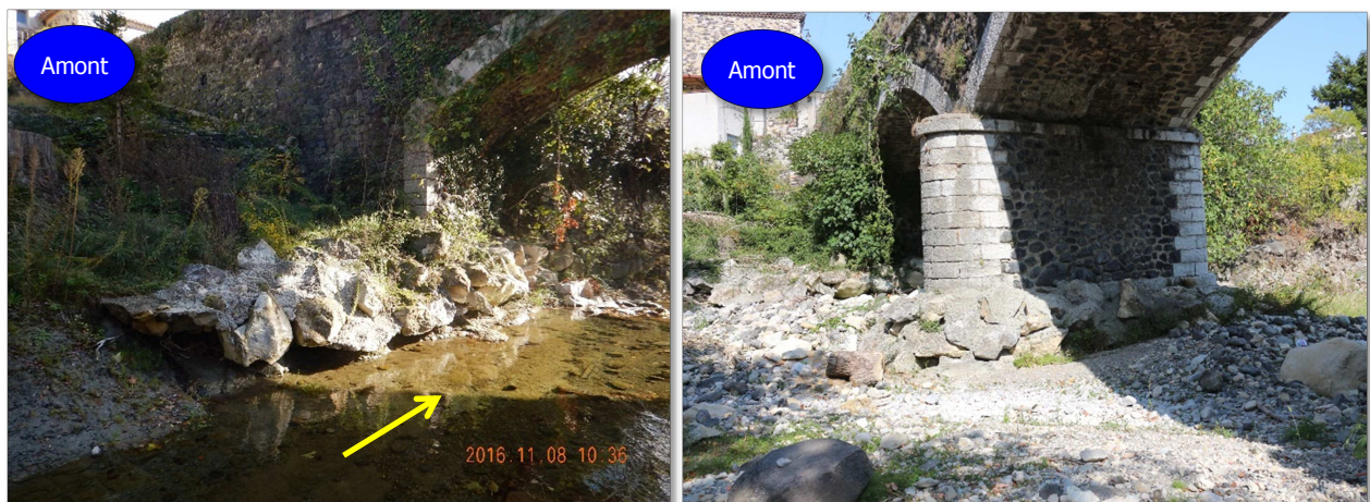
Figure 19 : appuis du pont de la Liberté, à gauche → culée C0 avec massif de renfort sous-cavé ; à droite → pile P1 partiellement reprise par enrochement bétonné
