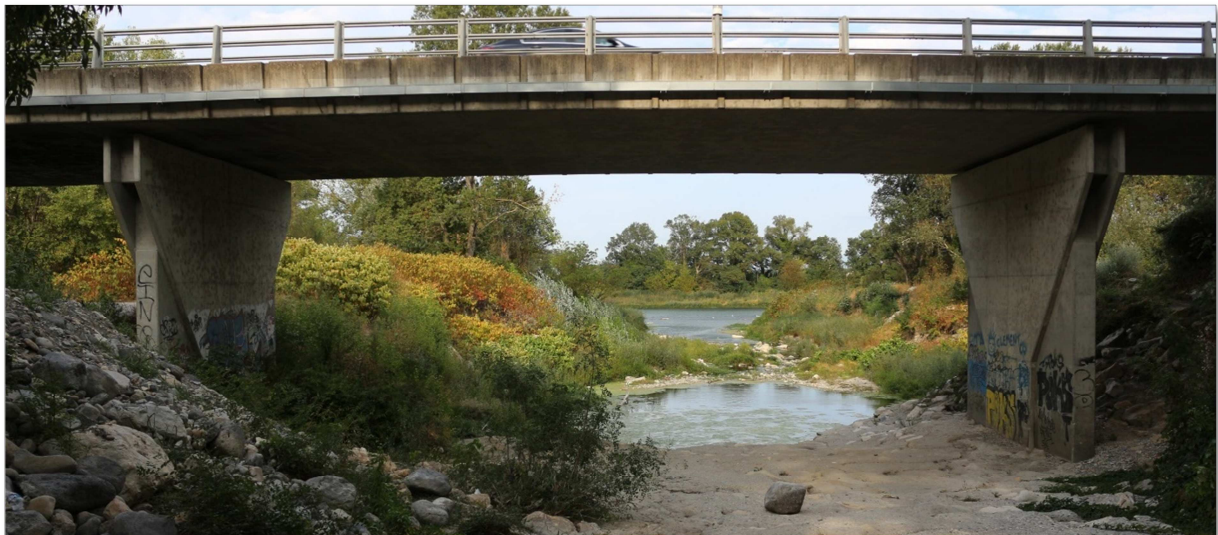
Figure 28 : vue partielle en élévation du pont de la RD 86, on note en aval la confluence avec le Rhône et surtout le décrochement du seuil parafouille partiellement déstabilisé et affouillé.
