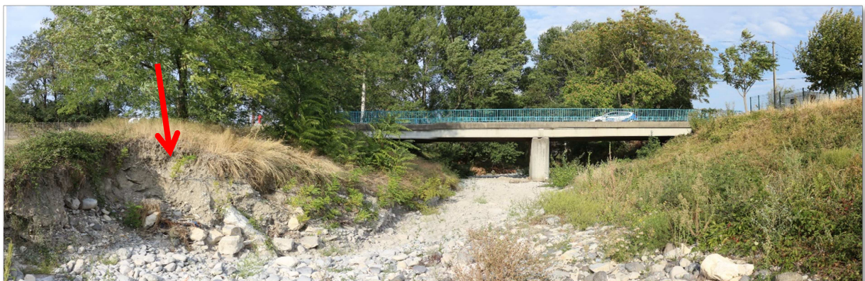
Figure 15 : Vue en élévation amont du pont de l'Europe Unie. On note le rétrécissement de section et le désaxement avec érosion de la berge de rive gauche.
