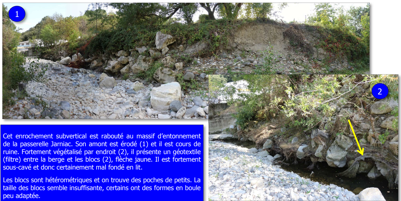
Figure 26 : enrochement en amont raboté à la passerelle Jarniac en cours de ruine
