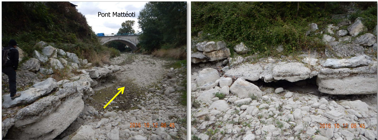
Figure 27 : ouvrage sous-cavé en amont du pont Mattéoti, à surveiller
