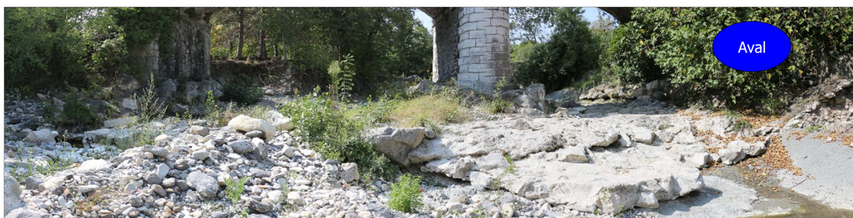
Figure 23 : état du radier parafouille encore visible notamment sous T1, vu depuis l'aval. Il est déstabilisé.
