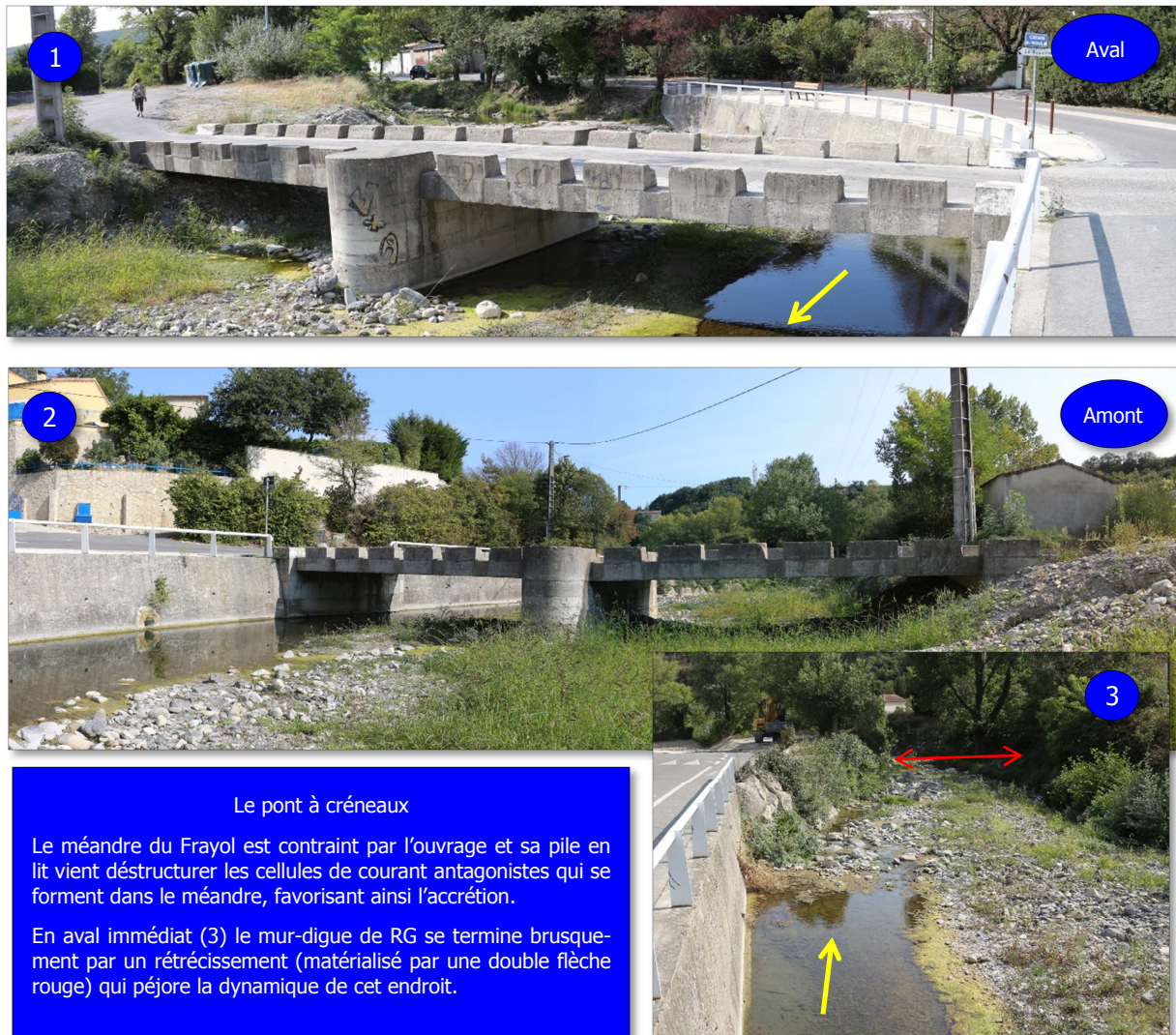
Figure 10 : Elévation aval (1) et amont (2) du pont à créneaux, (3) rétrécissement de section en aval immédiat du pont à créneaux
