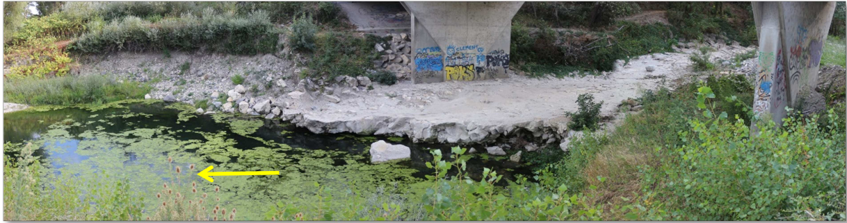
Figure 29 : vue aval RG du seuil parafouille partiellement ruiné. On note le décrochement important ainsi que l'érosion de berge.
