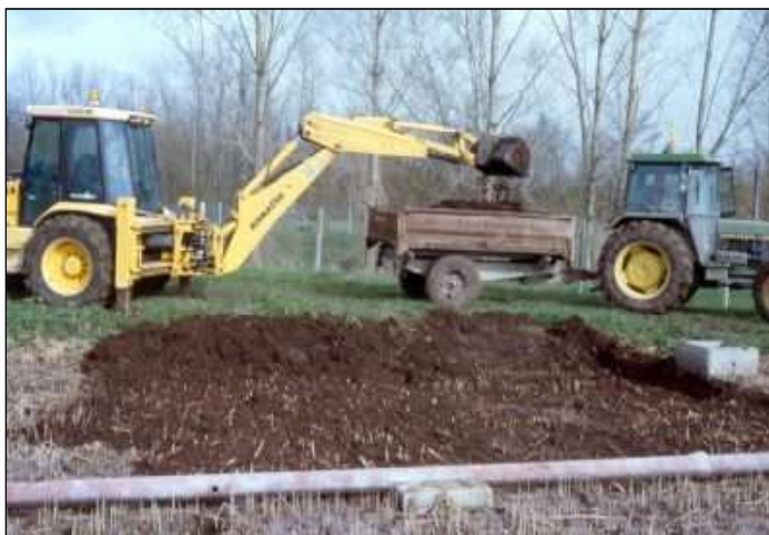
Fig. 6-c : Curage des boues d'une station d'épuration de type Filtres plantés de roseaux
