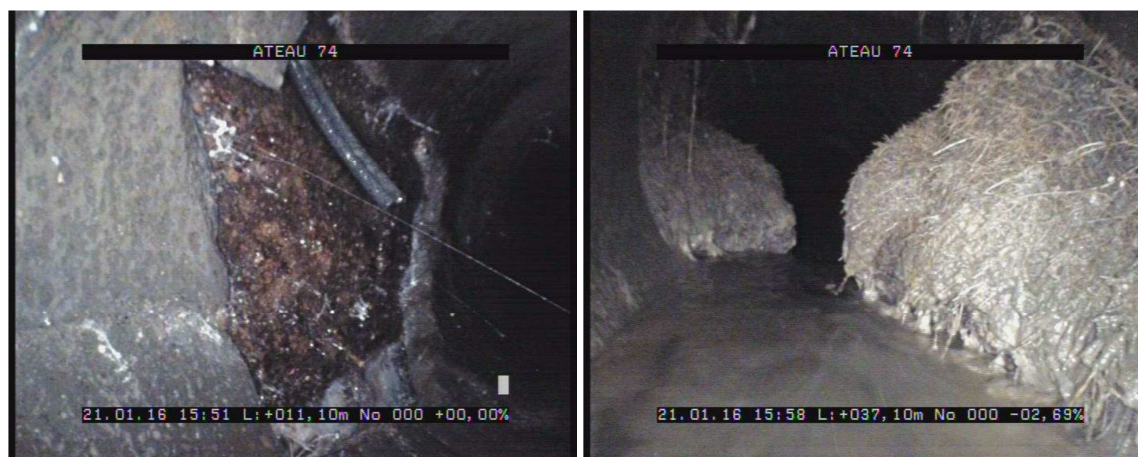
Fig. 4-a : Anomalies détectées par inspection caméra
