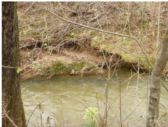
Figure 92 : Erosion en rive droite en aval du seuil
