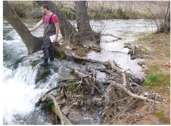
Figure 43 : Zone d'érosion au droit du point d'ancrage en rive gauche du seuil amont d'Entrecasteaux
