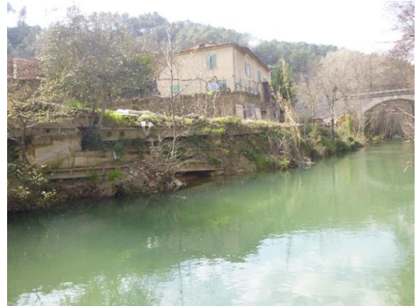
Figure 31 : Confortement de fortune de la berge rive droite en amont direct de l'ouvrage
