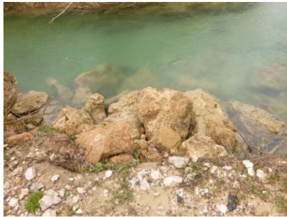
Figure 21 : Enrochements de protection de berges mis à nu suite à l'érosion des terrains en amont du seuil du Plan
