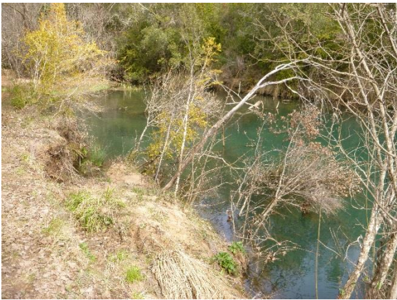
Figure 82 : Erosion de berge en rive droite
