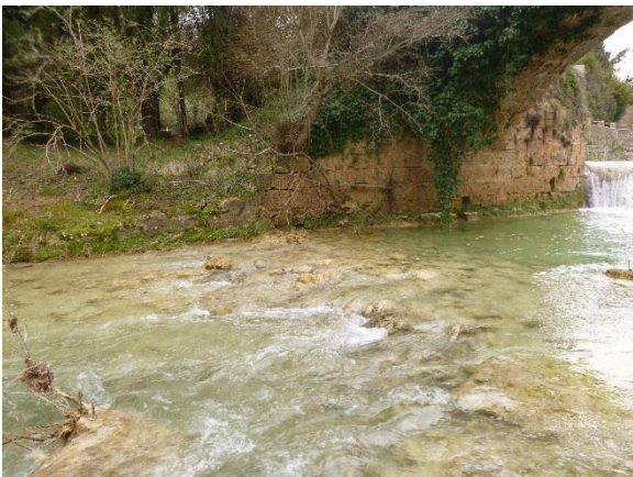
Figure 74 : Encroustement important des sédiments au niveau du radier en aval du seuil
