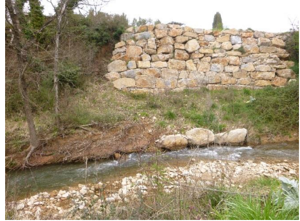
Figure 91 : zone d'érosion et protection en enrochement en extrados de courbure
