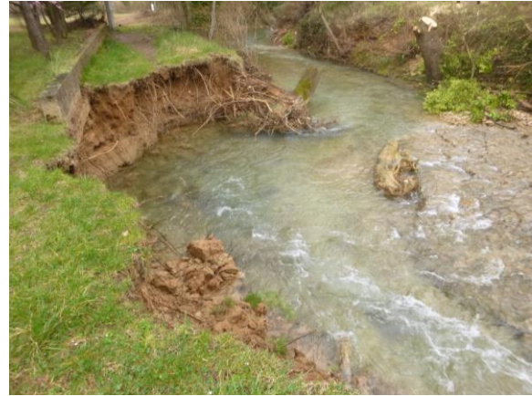
Figure 15 : Erosion en rive gauche au droit du muret délimitant la parcelle d'un riverain voisin
