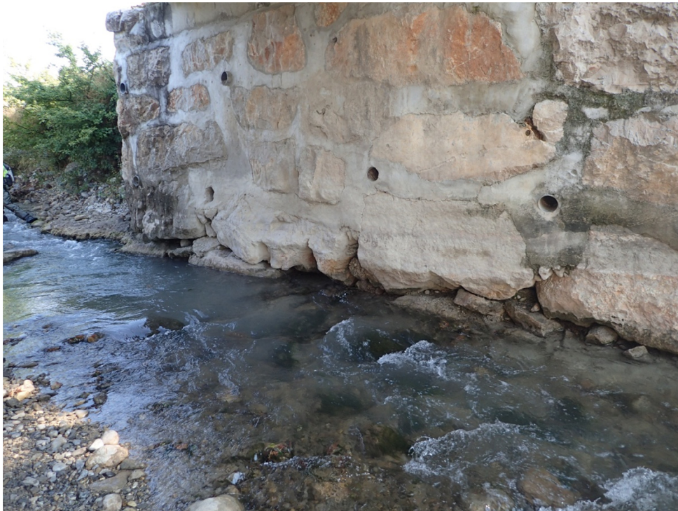
Figure 36 : Affouillement des piles du pont sur le Pesquier à sa confluence avec le Verdon Source : SIGosphère, 2016.
