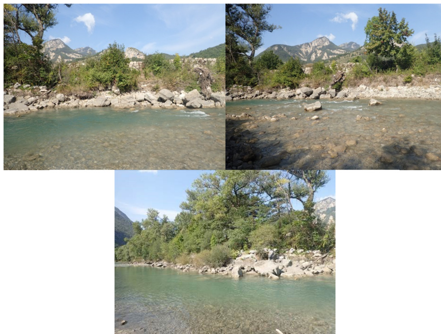
Figure 44 : Erosion sur la digue de la Barricade et destructuration des enrochements du pied de digue
