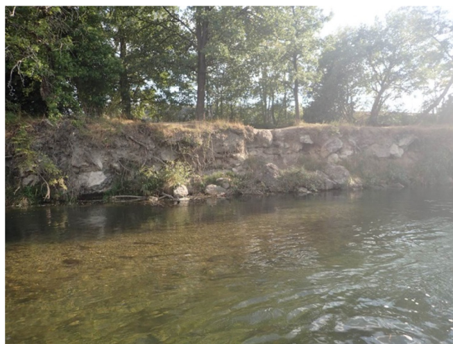
Figure 53 : Erosion sur la digue de la Barricade et déstructuration des enrochements du pied de digue
