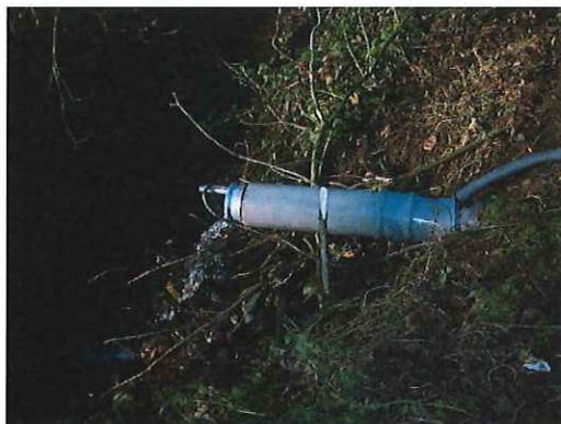
Débitmétrie en sortie de lagune
