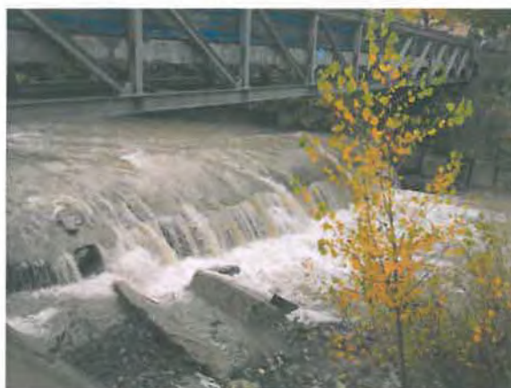
Figure 24 : seuil de la conduite d'eaux usées sur le torrent des Eaux Chaudes
